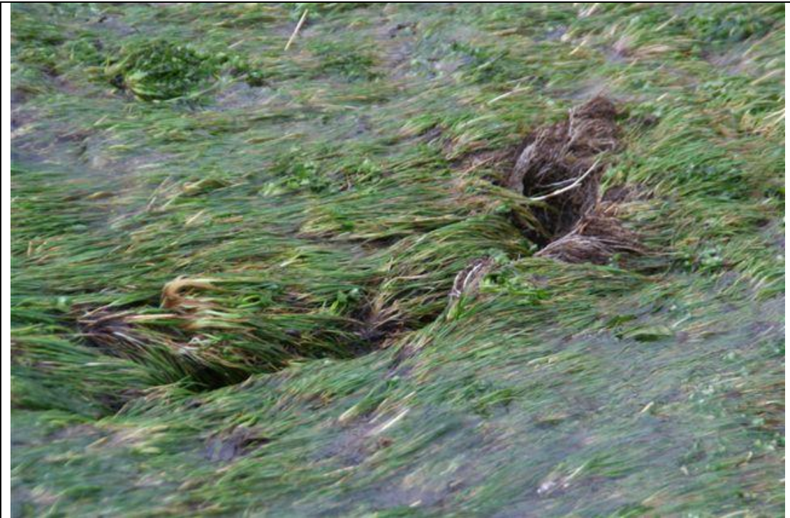
Duidelijke spleet zichtbaar waar water in kan komen
