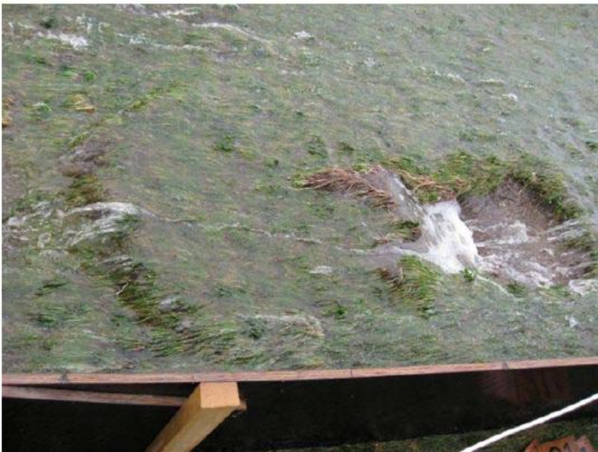
Figuur 4.3 Initiële schade teststrook 3
