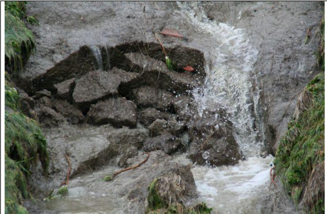
Kliferosie, head cut erosie gestart, zandkern niet bereikt 13:48 2138
