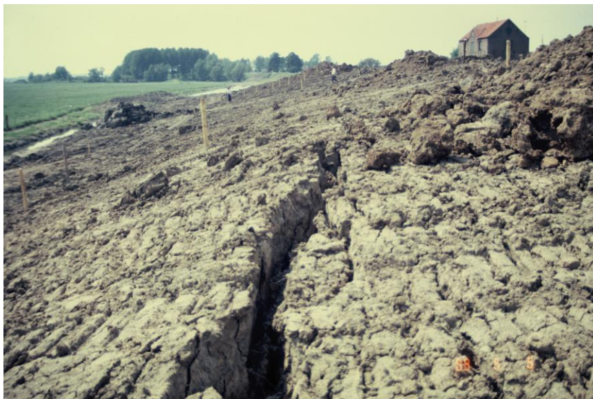
Figuur 15: Scheurvorming bij buitendijkse dijkverzwaring (linkeroever Lekdijk in de Alblasserwaard) met Euroklei in 1988 (Rijkswaterstaat / Dico van Ooijen)
