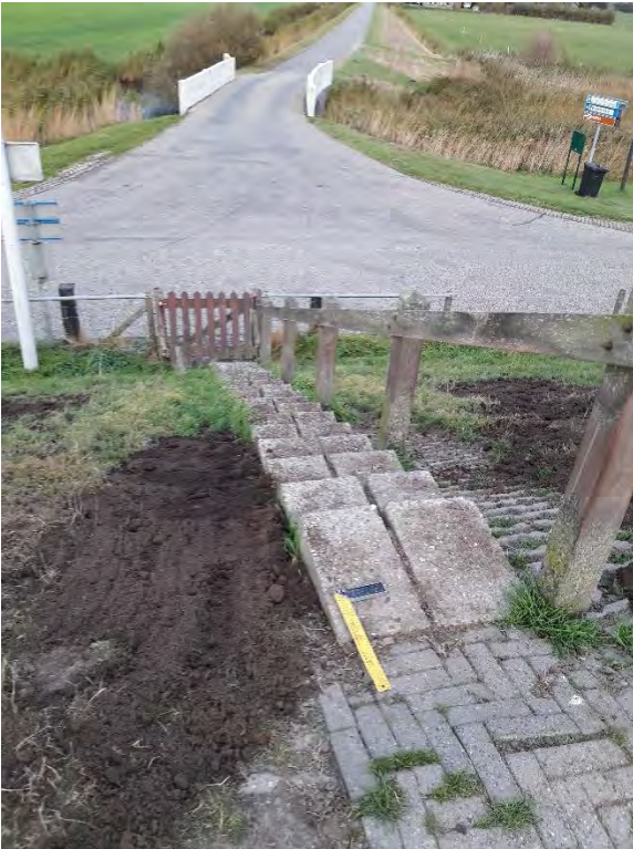
Figuur 6.2 Schade op de overgang tussen taludtrap en grasbekleding
