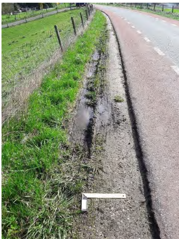
Figuur 5.3 Schade aan de grasbekleding in de berm van de rijweg voor uitwijkend verkeer
