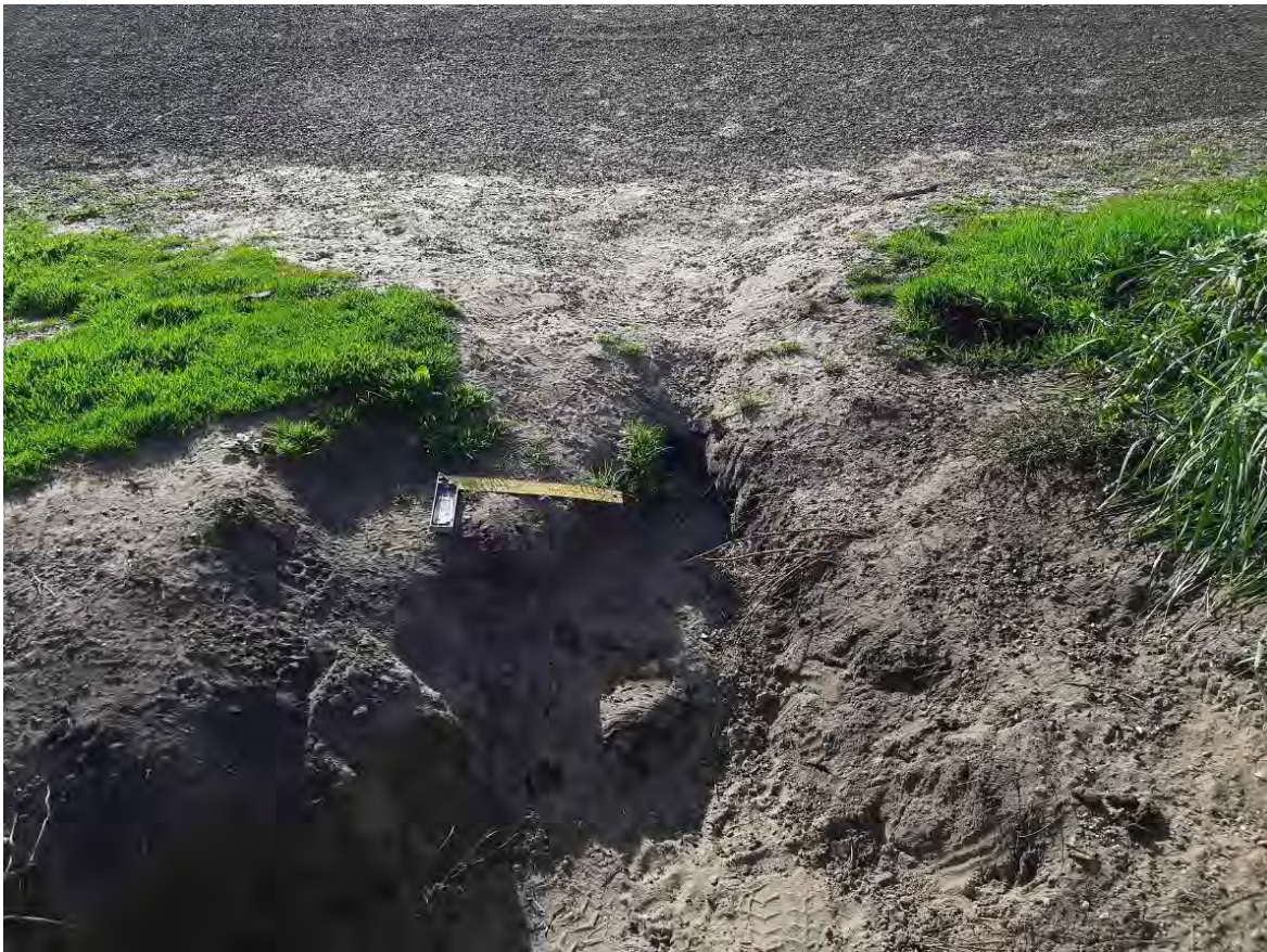
Figuur 2.3 Slechte situatie van een ontgroning bij een overgangsconstructie asfaltbekleding – voorland [Deltares (2018a)]
