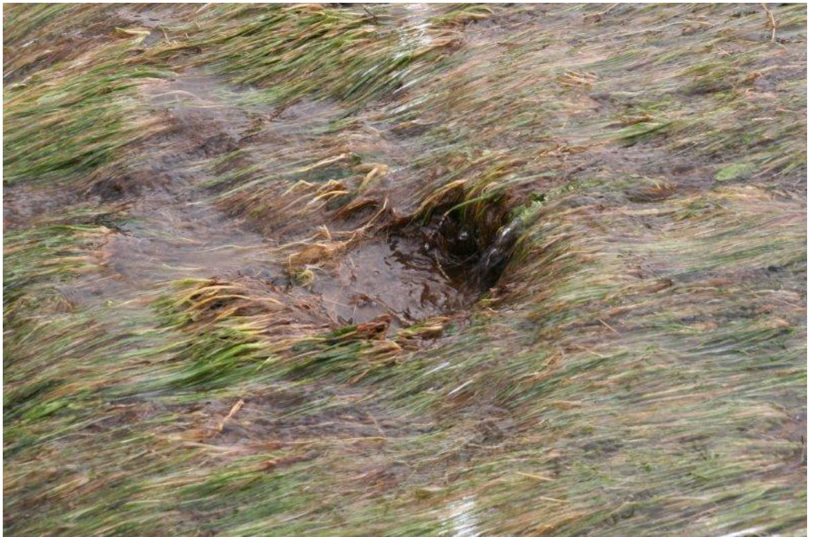
Foto B43 Vechtdijk. Zeeregime met boom, proef 2; Eerste schade aan talud
