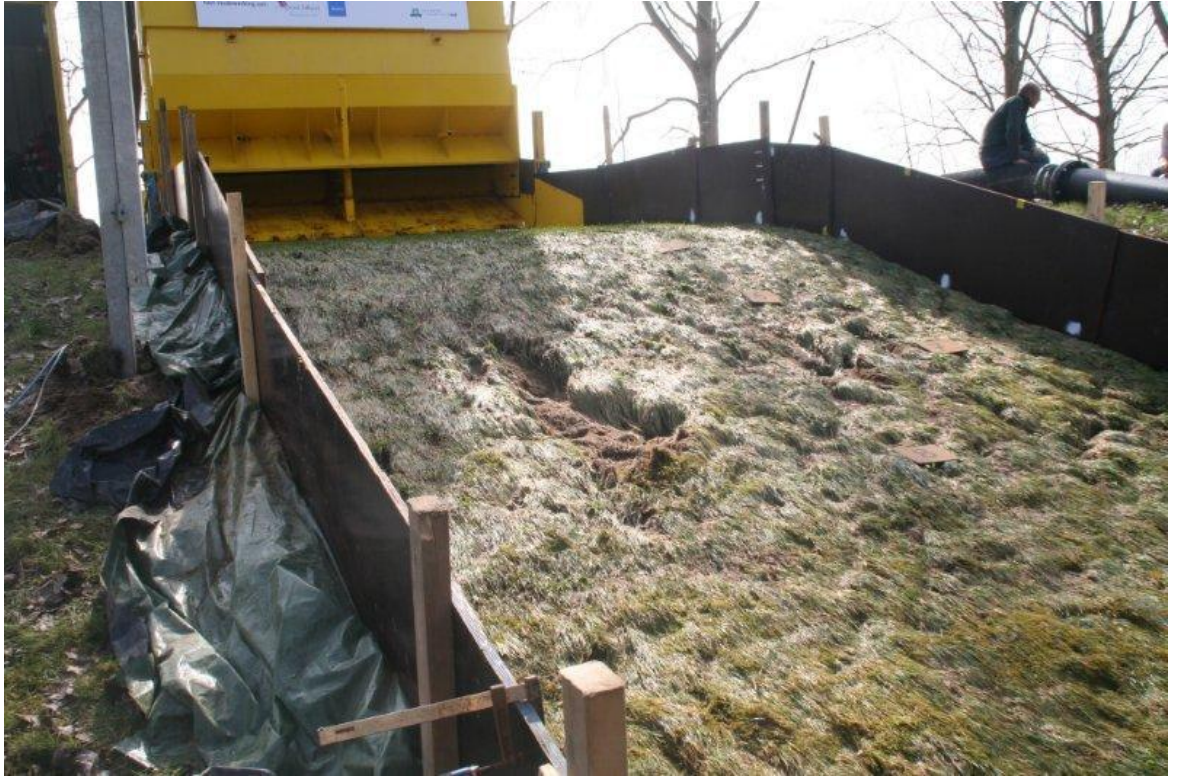
Foto B50 Vechtdijk. Zeer zwaar zeeregime, proef 3; Eerste schade talud
