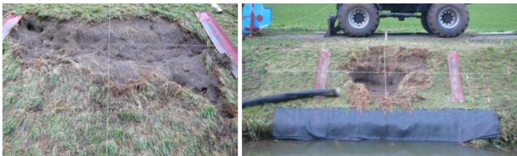
Figuur 3.3 Impressie schade aan het einde van de testen zonder overgangen. Links: Harculo (Ha.1) na 6014 klappen, rechts: Olst (Ol.1) na 3000 klappen
