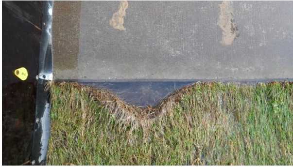
Figuur 3.21 Schade strook 1 aan het einde van de proef met 50 l/s per m
