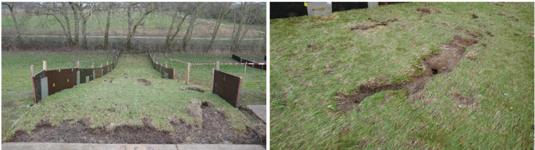
Figuur 3.22 Schade bovenaan het talud op de overgang van betonpad naar gras (links) en doorbraak van de toplaag op het talud (rechts), beide aan het einde van het proefprogramma
