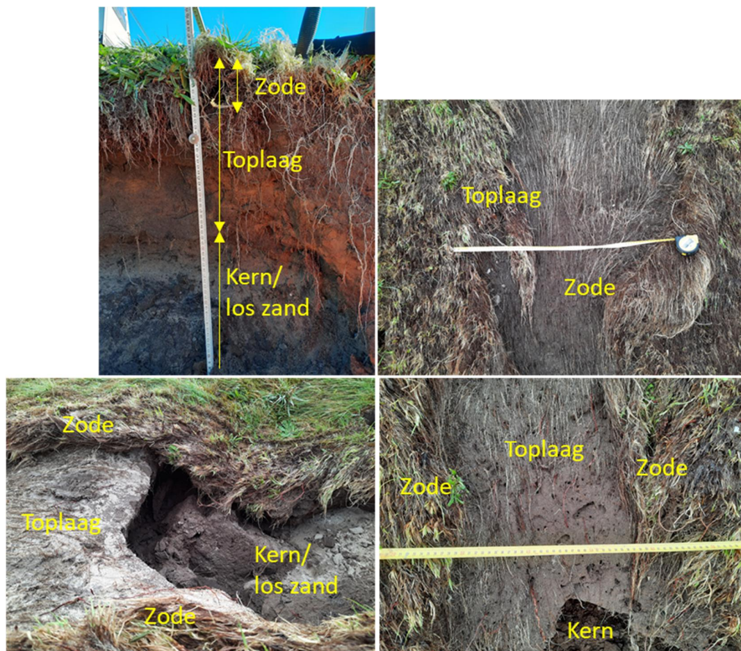
Figuur 3.6 Illustratie schade en doorbraak van de toplaag op de Vechtdijk, onderscheid tussen zode, toplaag en kernmateriaal (zode is onderdeel van de toplaag). Linksboven: toplaag doorgebroken; rechtsboven: schade; linksonder: toplaag doorgebroken; rechtsonder: toplaag doorgebroken
