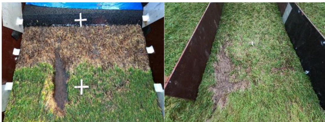
Figuur 3.7 Schade vak 4 bij de kruin(links) en vak 14 en 15 onderaan het talud (rechts)
