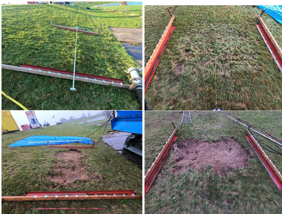
Figuur 2.2 Schadeontwikkeling Testsectie 1A (van links boven met de klok mee: voor de start, na 52 cycli, na 88 cycli en na 124 cycli) Geen falen toplaag
