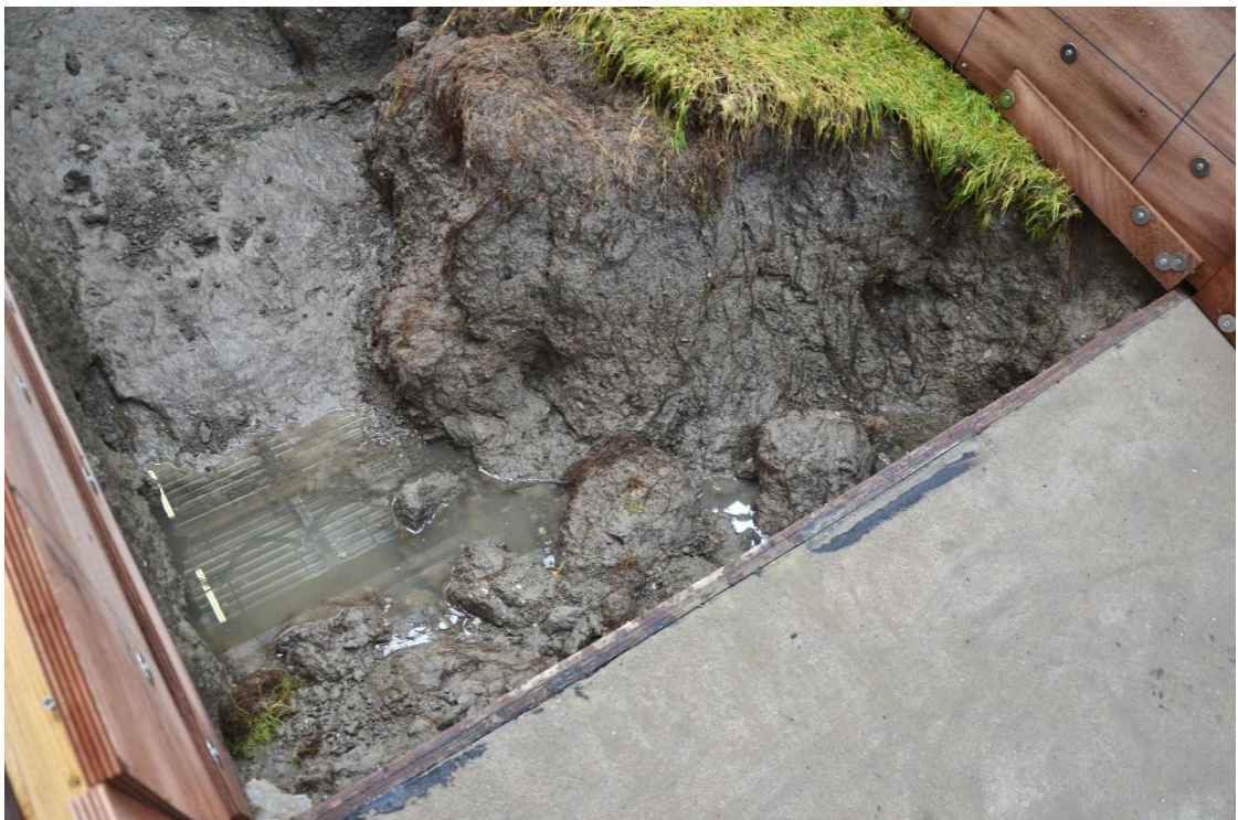
Fig. B-38 Erosiekuil na proef K1_09
