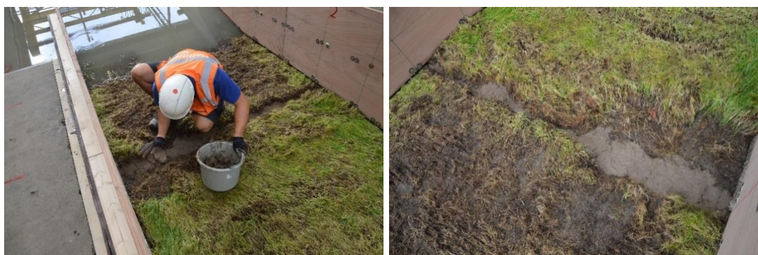
Figuur 5.4 Reparatie van de spleet tussen de eerste twee kleiblokken na proef K2_05
