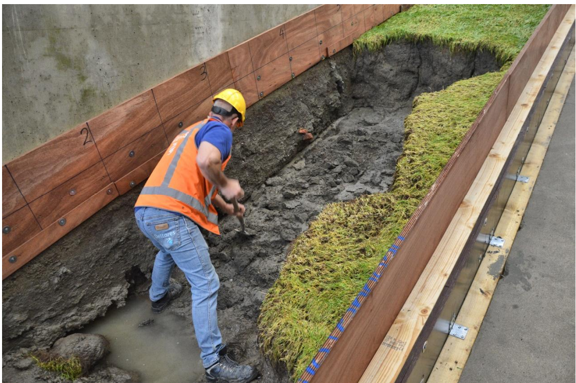
Fig. B-42 Kunstmatige schade aan bodem van erosiekuil omdat erosie moeite had om in de onderste rij kleiblokken te komen
