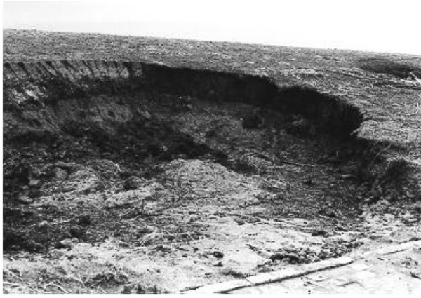
Fig. H-3 Schade bij km1,85
