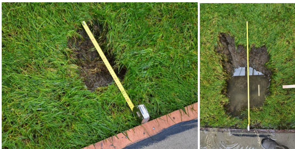
Figuur 5.1 Erosie van het gras. Situatie na proef K1_04 (links) en na proef K1_05 (rechts)
