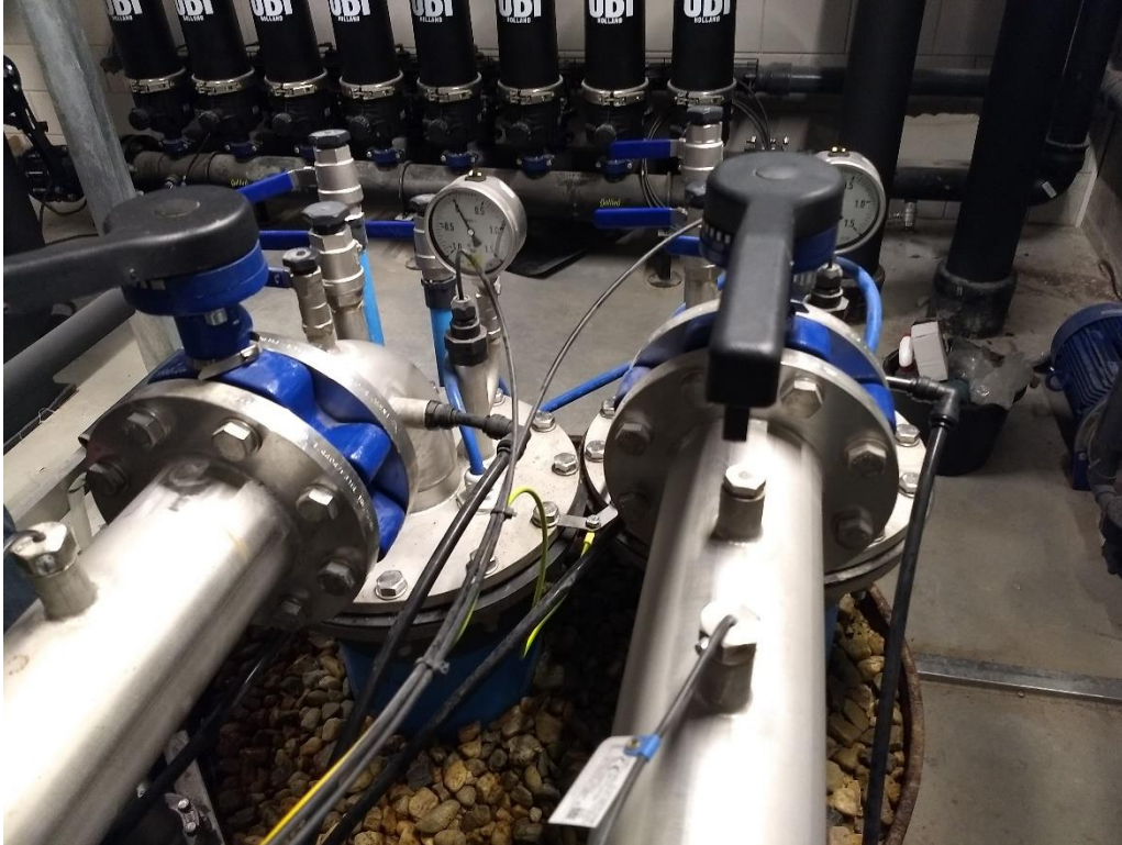
Figuur 2 | Technische ruimte (put) met op de voorgrond de monobron en op de achtergrond de filterpotten (discfilters)
