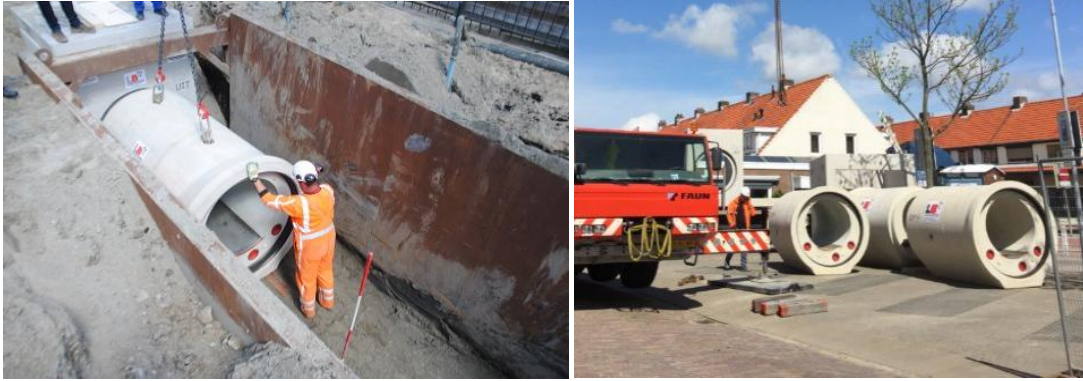
Figuur 4.2 Vrijvalrioolwarmtewisselaar intern prefab in de gemeente Goes (bron: warmtepompen.nl)
