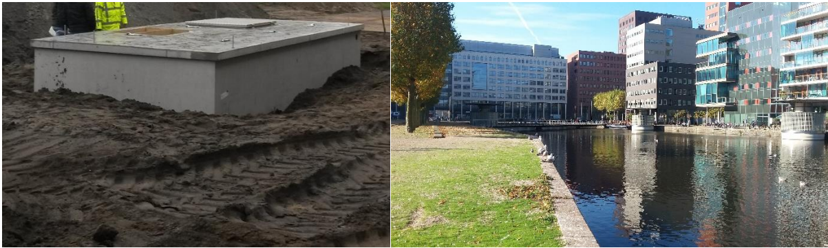
Figuur 3 | De ondergrondse TEO put met filters en pompen (links) en de projectlocatie, de Laakhaven (rechts)
