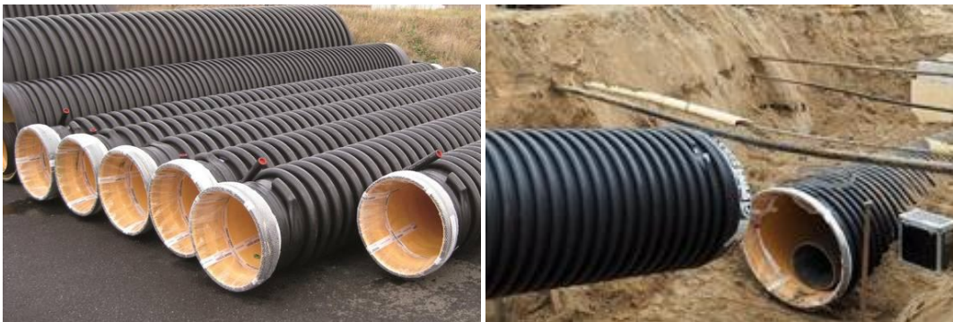
Figuur 4.3 Vrijvalrioolwarmtewisselaar extern prefab gemeente Velsen
