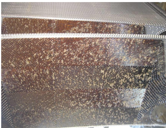
Figuur 10: Foto van vervuiling in een platenwarmtewisselaar in een industriële toepassing
