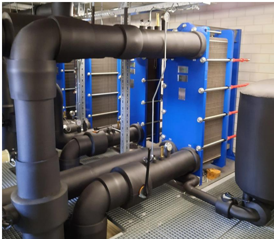
Figuur 3: Foto van een platenwarmtewisselaar in een aquathermiesysteem in Pijnacker
