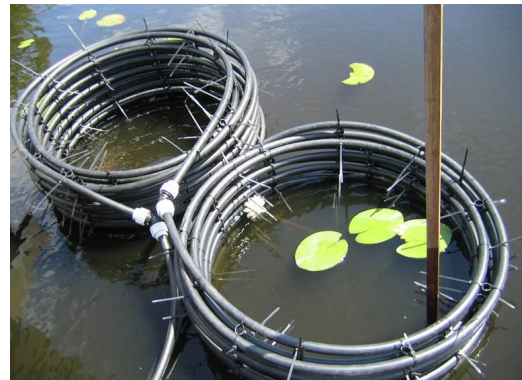
Figuur 7: Gesloten warmtewisselaar met slangen voor een TEO installatie (bron: Ynergy)
