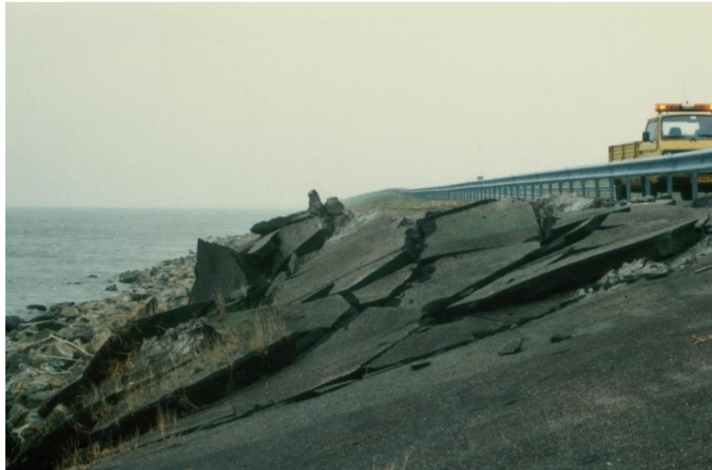
Figuur 4.3 Waterkeringschade door kruierend ijs. Markermeer, Houtribdijk, schade aan asfaltbekleding. Bron: https://beeldbank.rws.nl , Rijkswaterstaat / Hans Johanson.
