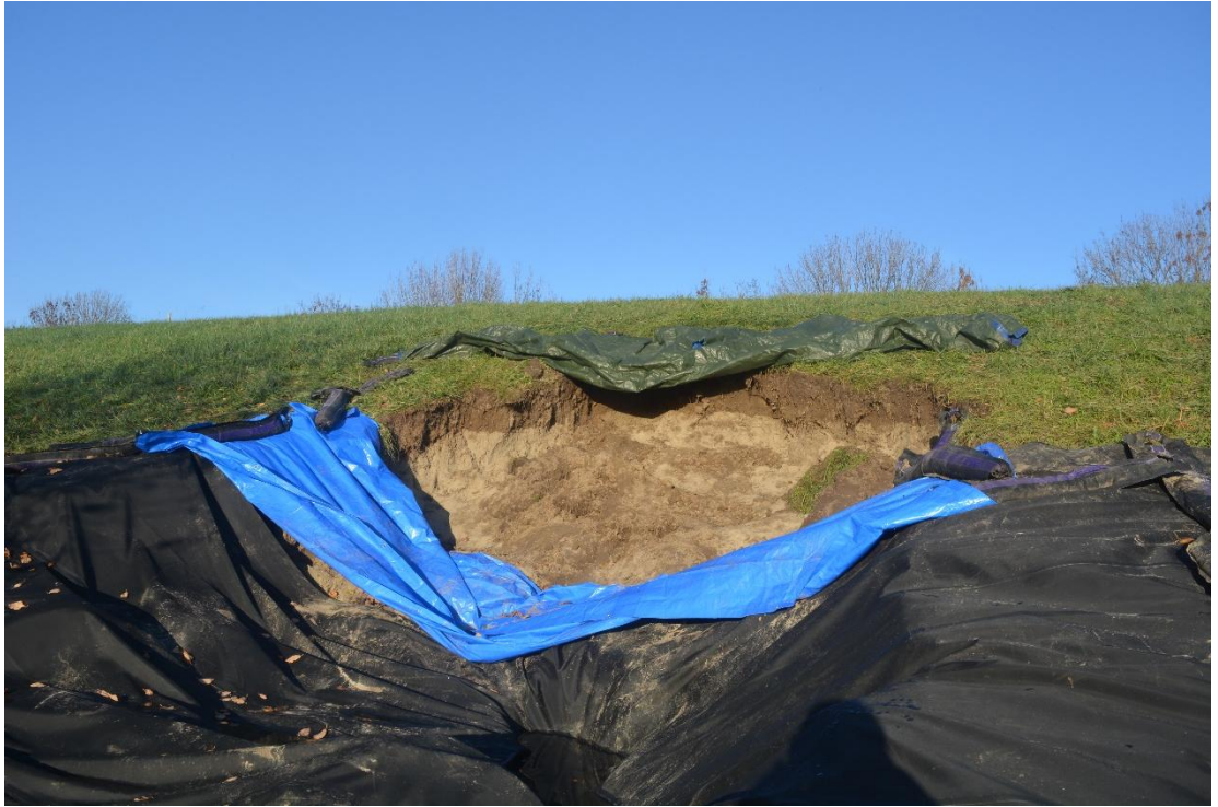
Figuur 2 Uiteindelijke schade bij schapenklif: een erosiegat van bijna zes meter breedte met een vrijliggende zandkern. Foto van 23 november 2020.
