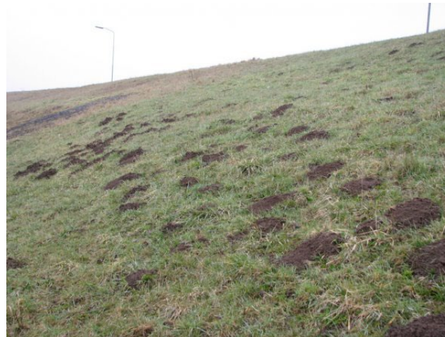
Figuur 2. Door graverij beschadigde grasmat op een dijktaalud.
