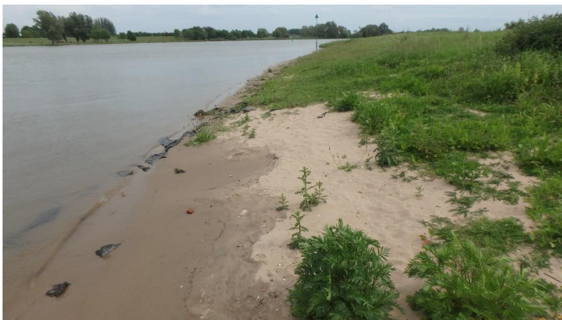
Figuur 2.3 De overgang van een zandige oever naar een beschermde oever (met geotextiel en stenen tot 20 cm). Tussen deze locatie en de veerstoep is de oever van de binnenbocht ontsteend (foto Kees Sloff mei 2019).
