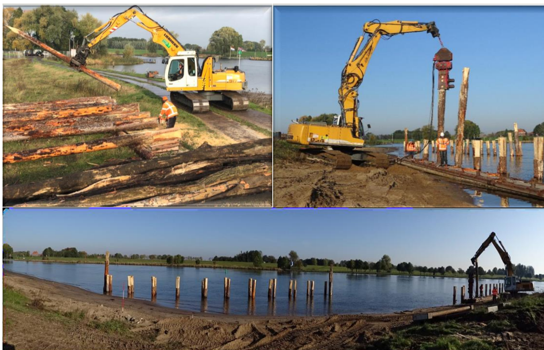
Figuur 3.4 De realisatie van de houten schermen (foto BAM / Van den Herik, begin November 2019).
