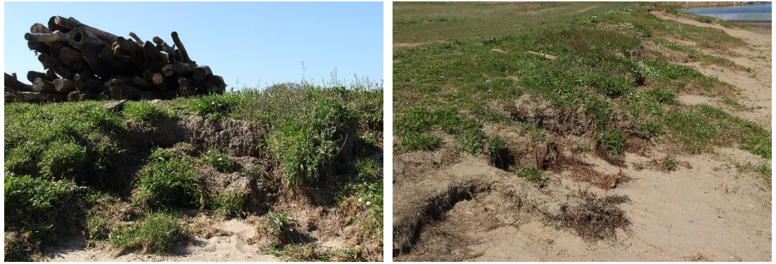
Figuur 5.4 Oevererosie ter hoogte van het derde scherm.
