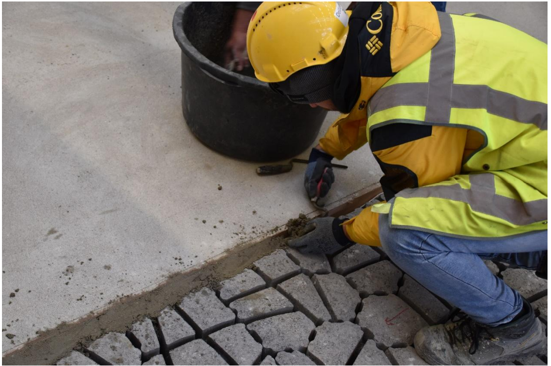
Fig. E-5, Het opvullen van de spleet tussen de steenzetting en het boventalud met zandcement
