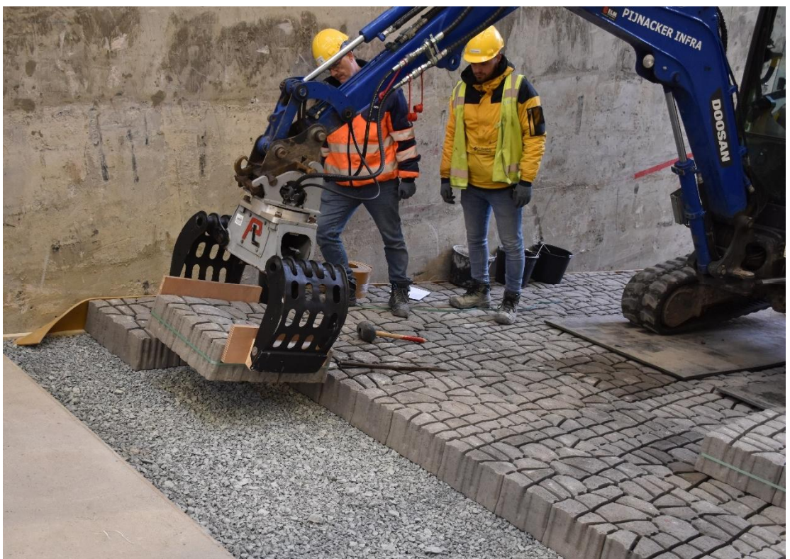
Fig. E-4, Plaatsing RONA ® ton XL op het filter met behulp van minikraan met sorteerknijper
