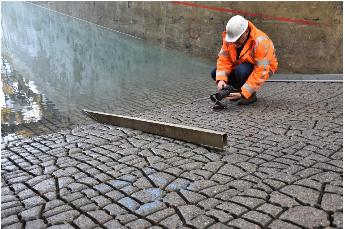
Fig. E-12, Inspectie van het talud na proef RXL-08 (een deel van de oneffenheden was reeds bij de aanleg aanwezig)
