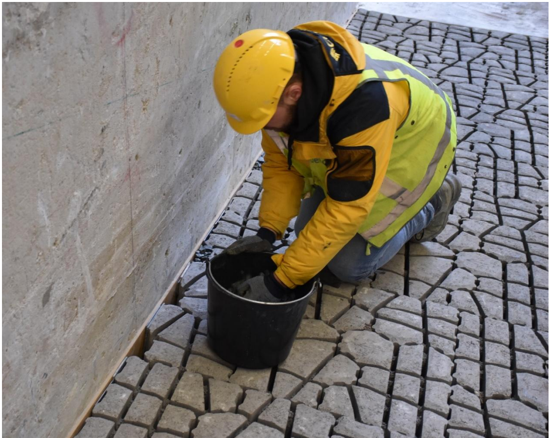
Fig. E-6, De ruimte tussen de zetstenen en het rubber is opgevuld met vulplaatjes en de overgebleven openingen tussen de zetstenen en het rubber is opgevuld met steenslag
