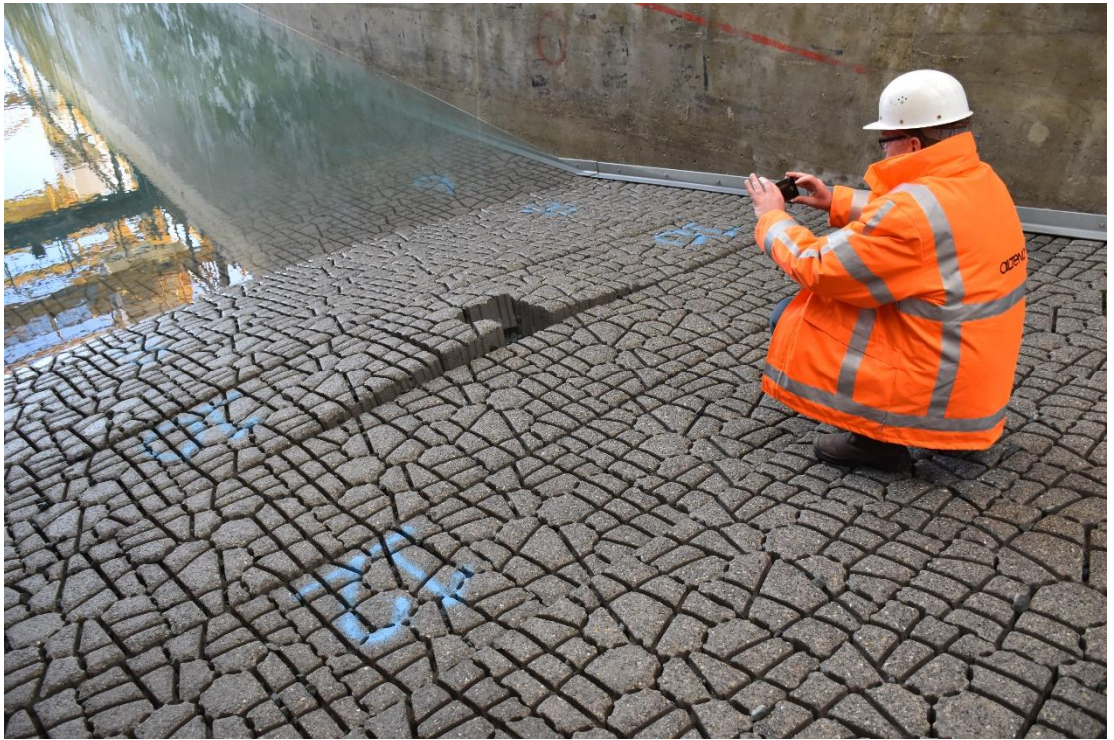
Fig. E-20, Schade na proef RXL-13
