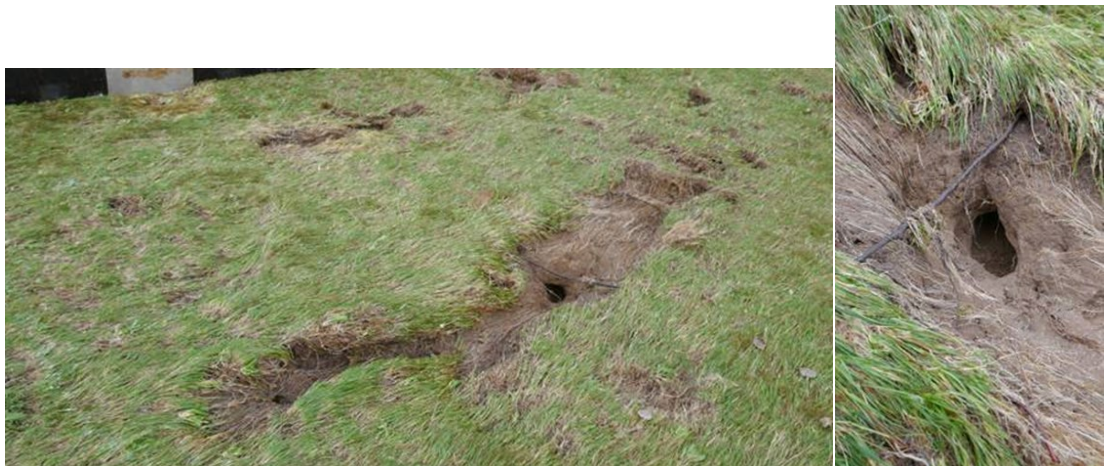
Figuur 8 Schade na een overslagdebiet van 50 l/s per m [Infram, 2021]
