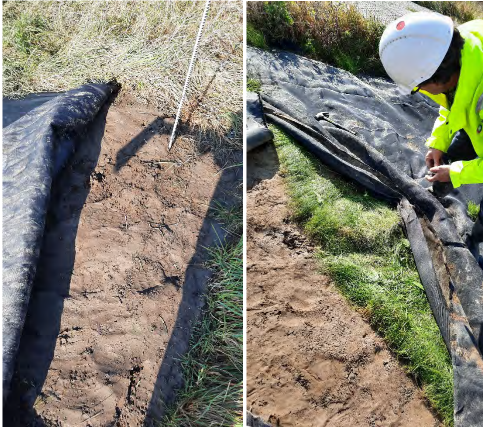
Figuur 38 Er is een duidelijk verschil in vegetatievorming: onder het dichtgewoven PE-doek is de kleigrond nog volledig kaal, onder het lichte en meer lichtdoorlatende PP-doek heeft zich een dichte graszode gevormd.
