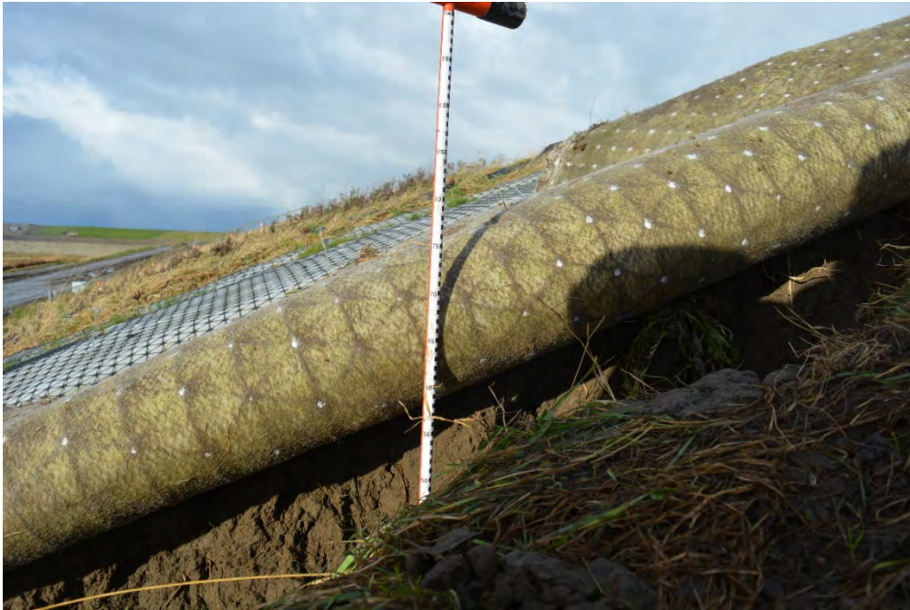
Figuur 74 Blik op erosiegleuf halverwege het talud. De gleuf is ca. 55 cm diep.
