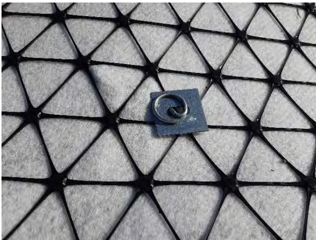
Figuur 15 Gripple Terra-Lock-pen zit volledig tegen de contraplaat ("washer") aan, maar er is geen volledig contact tussen de washer en het grid van het Tensardoek.
