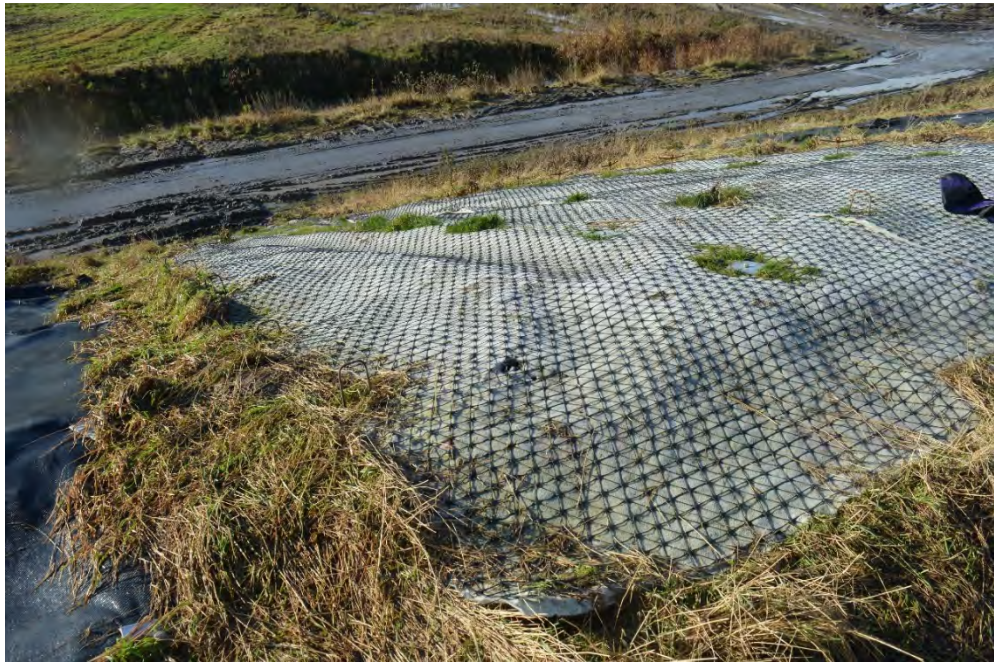
Figuur 64 Bekramming een week na de overloopproof. Zicht vanuit de kruin naar beneden.
