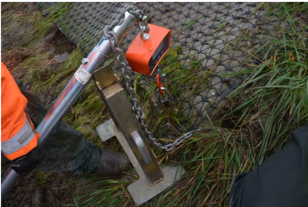
Figuur 63 bepaling van de ankerkracht van de Y-krammen. Rechts naast de ketting is een gat als restant van de verankering van de houten schotten te zien.
