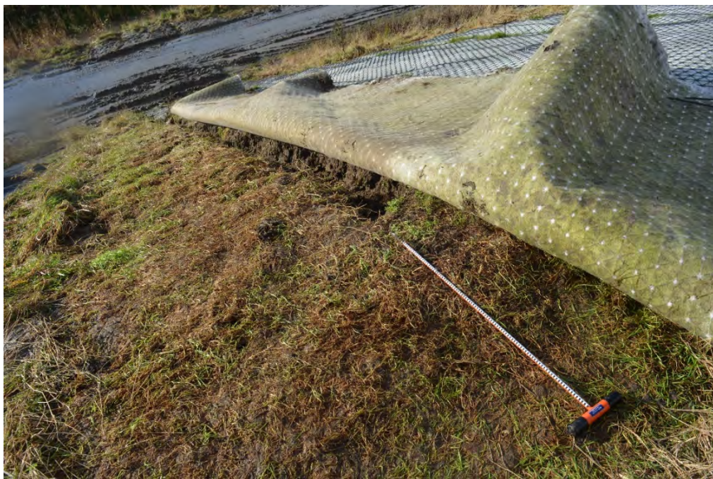
Figuur 71 Onder het iets verder opengelegde talud is duidelijk de erosiegleuf te zien die zeer breed en diep is uitgespoeld. Deze erosiegleuf komt overeen met de spoorvorming van de graafmachine. De graszode daarnaast lijkt redelijk intact.
