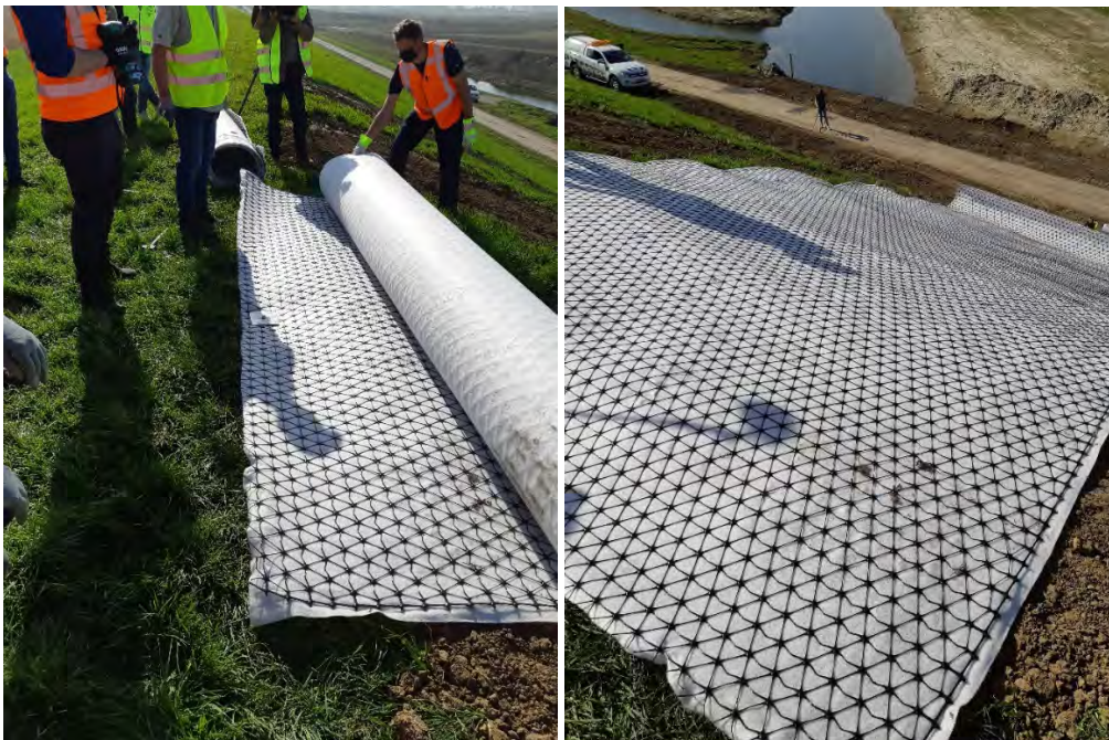
Figuur 8 Plaatsen van de bekramming op het binnentalud met een Tensardoek. De baan doek wordt hier aan de kruin van de dijk met een Wurmi-pen in het midden van de rand van het doek gefixeerd en de baan wordt daarna naar de teen toe afgerold.
