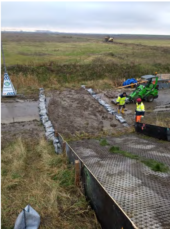
Figuur 59 Een grote hoeveelheid klei en slib is geërodeerd en op de asfaltweg terechtgekomen.
