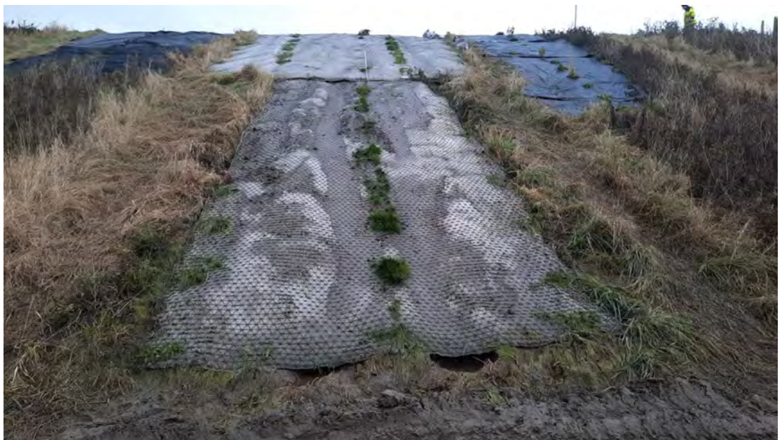
Figuur 61 Duidelijk zichtbaar zijn twee brede erosiegleuven over de hele lengte van het benedengelegen Tensardoeck. Achteraf bleken dit de met losse klei opgevulde rijsporen van de graafmachine te zijn.
