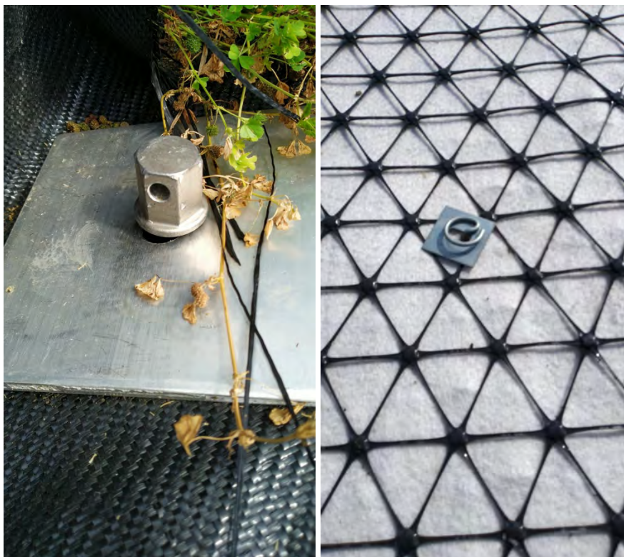
Figuur 29 Zowel de Wurmi schroefharing (links) als ook de Gripple Terra-Lock-pen zijn iets los komen te zitten. Er is circa 3-5 mm afstand tussen de contraplaat en de kop van de pennen.
