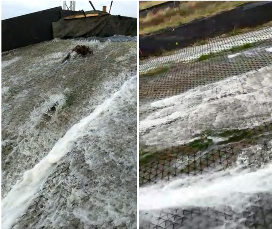
Figuur 56 Verdeling van het afstromende water over het doek dicht bij de kruin (links) en circa 4 m lager (rechts). Een groot deel is al door het doek heen gesijpeld en stroomt onder de bekramming verder.
