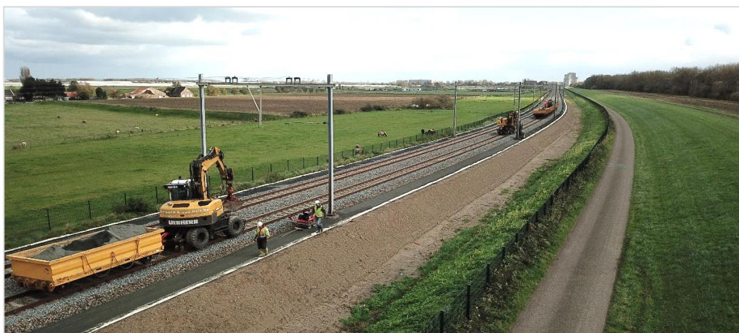
Aanleg van een schouwpad langs het spoor van de Hoekse Lijn (Foto: F. van Dijk, 2019).
