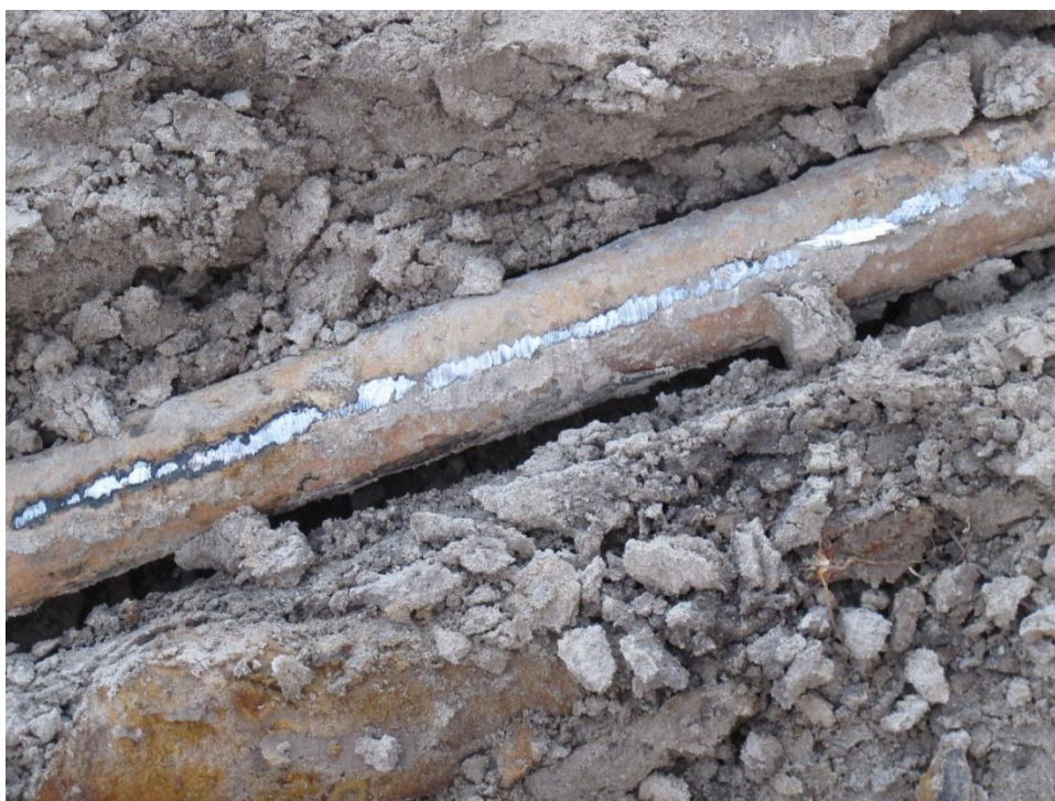
Figuur A.7 Beschadiging tgv graafwerkzaamheden.
