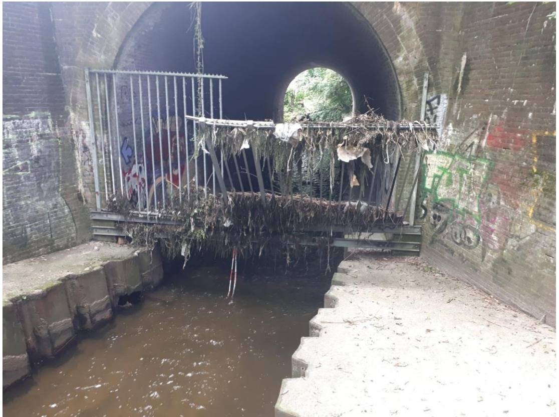
Figuur 16 Spoorbrug Anselderbeek in juli 2021 na het hoogwater. In november 2021 heeft het waterschap (de restanten van) het hek verwijderd. (foto: Wim Bosten, gemeente Kerkrade)
