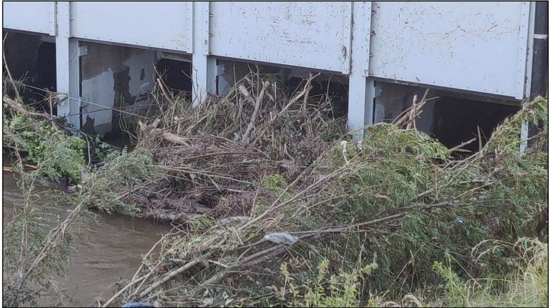
Figuur 4.6 Drijfvuil bij de inlaat van de sifon na afloop van het hoogwater van juli 2021 (Foto ontvangen van Waterschap Limburg)
