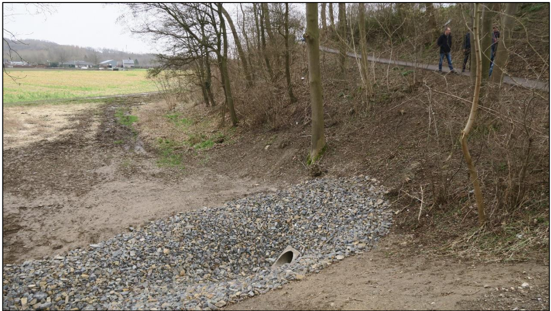
Figuur 3.14 Foto's van de duiker na het hoogwater op 4 februari 2022. De grond rondom de duikers is vrij gegraven en de bodem is verdedigd. Boven: Zuidkant van de brug (foto: J. de Jong), Onder: noordkant van de brug (foto: N. Asselman)
