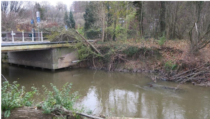
Figuur 14 Oevererosie achter brug en straat Polfermolen als gevolg van hoge stroomsnelheden (foto Nathalie Asselman)
