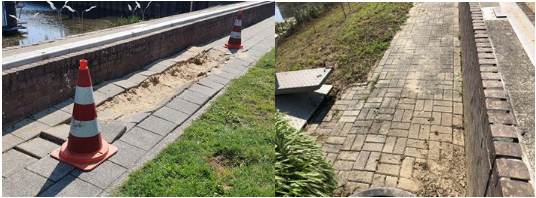
Figuur 3.18 Omgewoelde zandlaag binnendijks en uitgespoelde voegen buitendijks bij locatie (1) na hoogwater.
