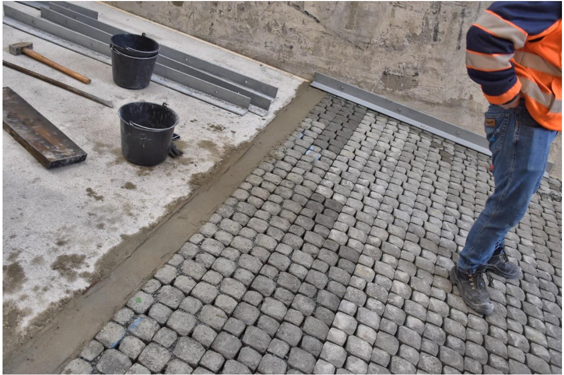
Fig. E-5 De spleet tussen de steenzetting en het boventalud is opgevuld met zandcement
