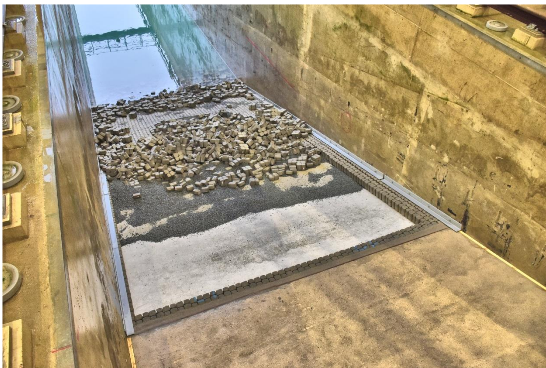
Figuur 4.4 Tijdens QB-07 zijn zetstenen uit de bekleding gespoeld
