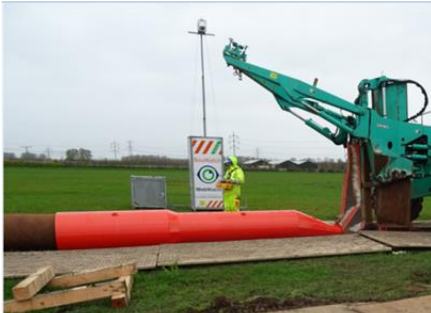
Figuur 3.1 Ploeg met aangekoppelde leiding, de oranje-rode buis is de zogenaamde torpedo (foto: Deltares).
