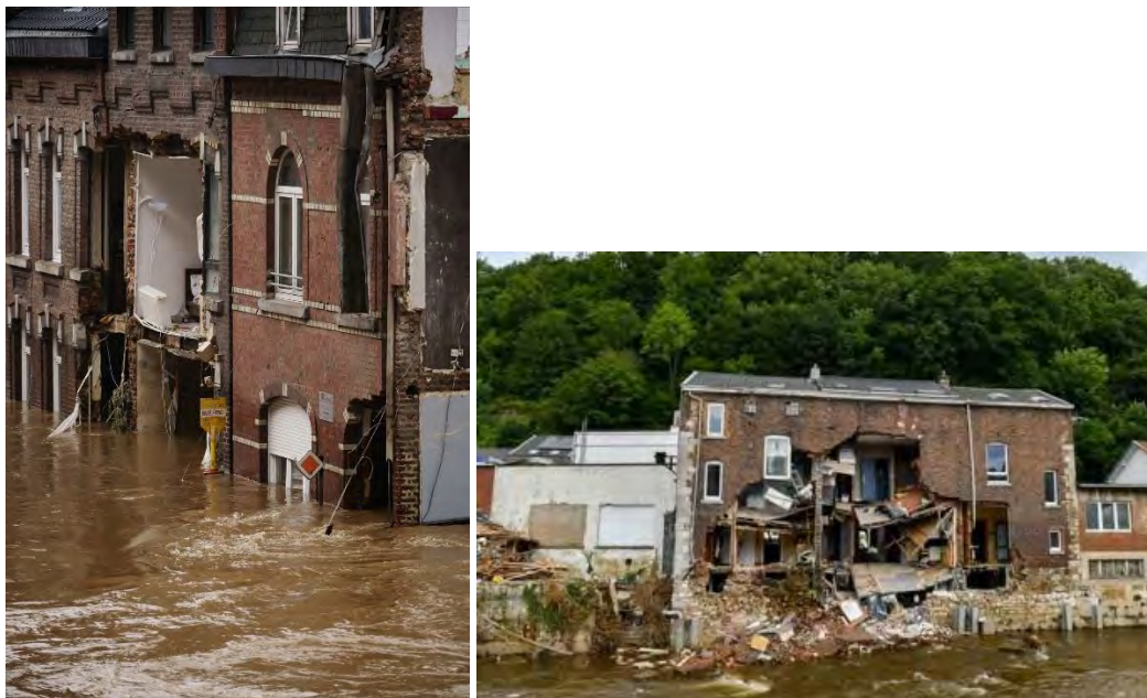
Figuur 2.6 Schade aan huizen in Pepinster (Vesdrevalllei).
