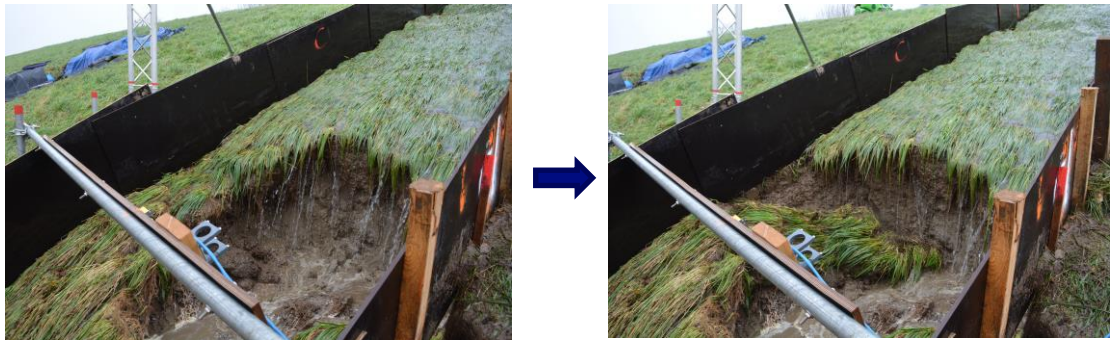
Figuur 2.2 Erosie van de deklaag (en gelijktijdig van de zandkern eronder) in een vergevorderd stadium.
