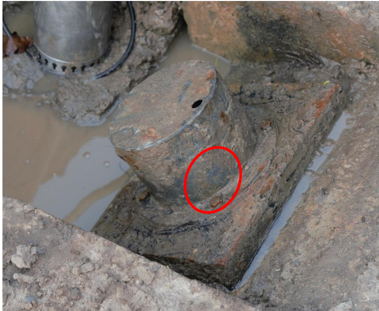
Figuur 4.2 Aangetroffen ankerkop met rode markering van het lek.
