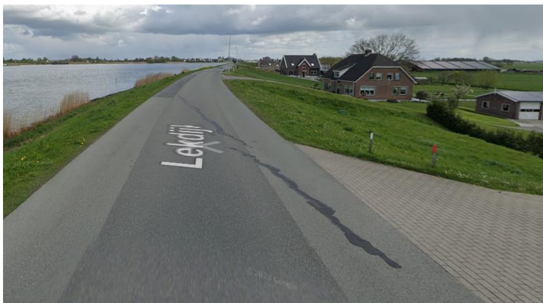
Figuur A.25 Google® streetview foto van april 2023 met daarop scheurvorming, startend vanaf de oprit bij het pand. De scheurvorming is ter plaatse van de oprit naar pand 59 zichtbaar langs de buitenzijde van het asfalt.
