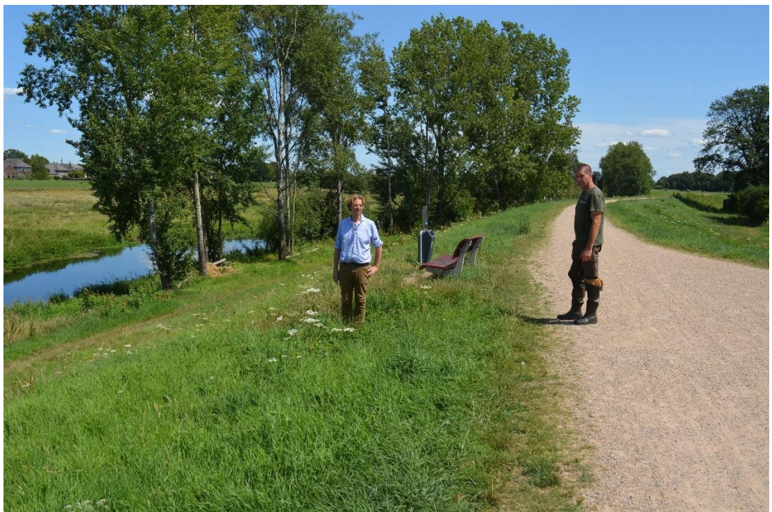
Figuur A.3 Een verzakking nabij de kruin van de dijk, wellicht veroorzaakt door bevergraverij.
