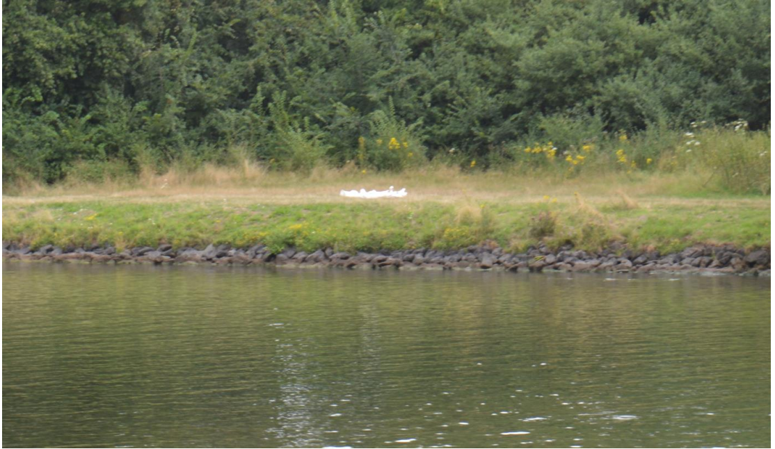
Figuur B.2 Oever met stortsteen langs het Julianakanaal nabij de Illikhovenbrug in Echt-Susteren. Ook op de locatie graven de bevers een gang onder water tussen de losse stortstenen.
