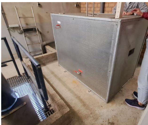
Figuur 23: Eén van de twee noodaggregaten
