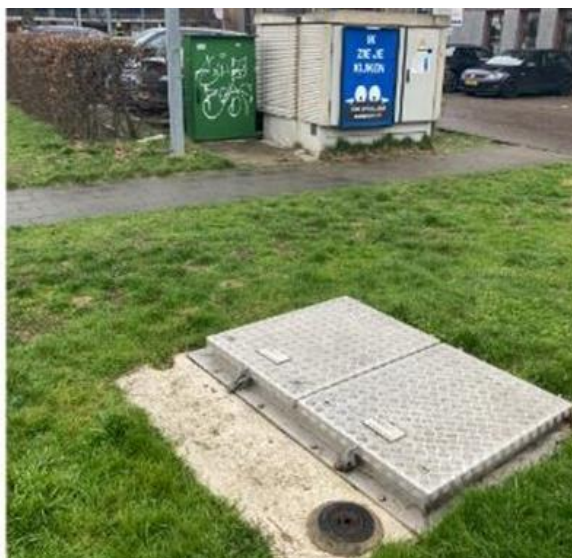
Figuur 33: Voorbeeld twee-pomps-nat gemaal (groene kast is bedienkast, tranenplaten zijn de luiken naar de 2 pompompen)
