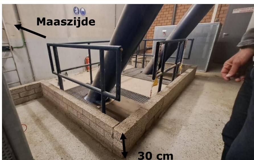
Figuur 21: Muurtje ter bescherming van apparatuur. Op de achtergrond het noodaggregaat en toegang tot elektraruimte
