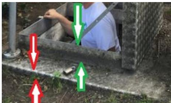
Figuur 34: Voorbeeld twee-pomps-droog gemaal met een entree-luik naar droge ruimte met motoren, schakelkast etc. Het luik sluit met rubber profiel (kan lekken bij veel waterhoogte/druk boven dat profiel)
