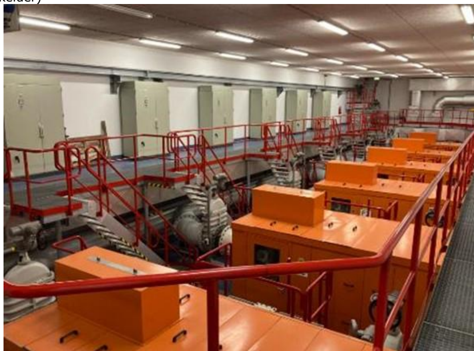
Figuur 28: Voorbeeld van een boostergemaal (West-Postjesweg). De schakelkasten en Frequentie-Omvormers staan zelfs op de 1e verdieping.
