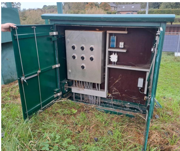
Figuur 25: Schakelkast afsluiter vispassage
