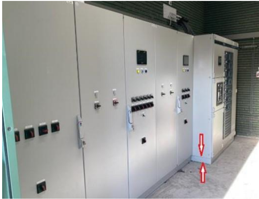
Figuur 29: Nieuw beleid (voorkeurs optie): schakelkasten en FO's staan niet meer in ondergrondse droge kelder maar in de ruimte boven het maaiveld, de kasten minimaal 10 cm boven de grond
