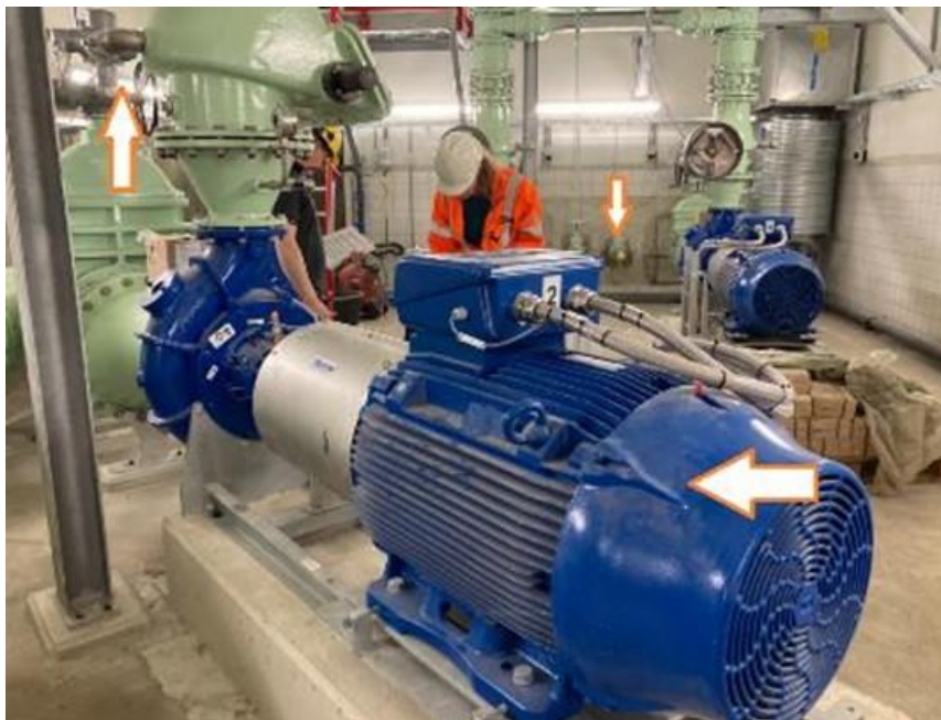
Figuur 31: Nieuw beleid 2: evengoed in ondergrondse ruimte (kelder) diverse kwetsbare objecten: elektromotoren, Auma's (elektrische afsluiters) diverse sensoren etc
