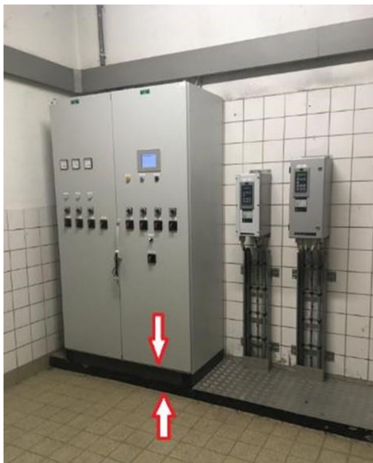
Figuur 27: FrequentieOmvormers (FO's rechts) in de droge kelder van een clustergemaal of Twee-pomps-droog gemaal. Kast staat op een sokkel van minimaal 20cm de FO's nog hoger. De FO's zijn spatwaterdicht.
