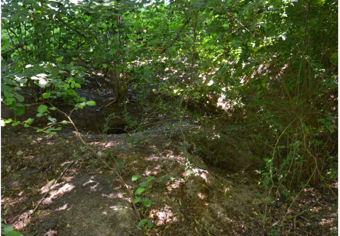
Figuur bijlage A.32 Gedeelte van een dassenburcht in een regionale kering nabij Beilen. Meerdere graafpijpen zijn zichtbaar, maar lang niet alle graafpijpen van deze burcht staan afgebeeld (foto: André Koelewijn).
