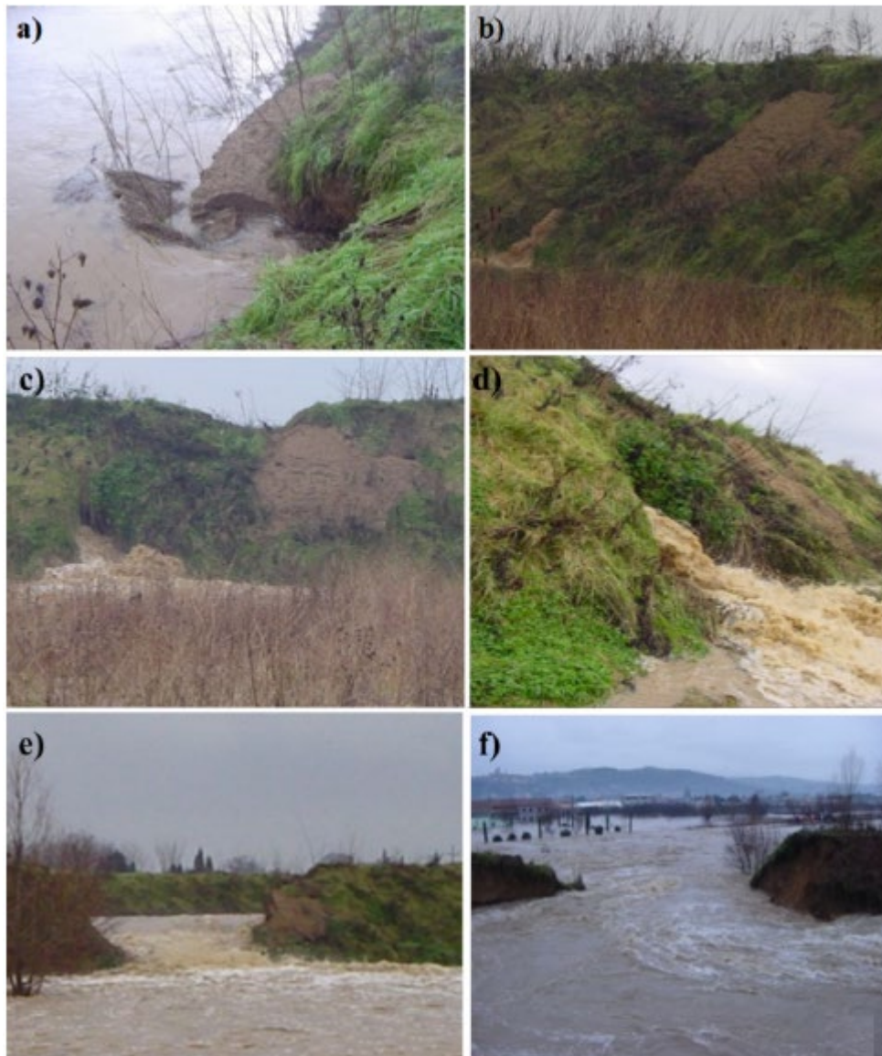
Figuur bijlage A.35 Faalproces van de dijk langs de Foenna. a) graafpijp aan de waterzijde waarin water wegstroomt, b) door gravende dieren verwijderde grond aan de landzijde, c) uitstroom van kwelwater uit het landzijdig talud, d) begin van verzakking van de kruin, e) en f) ontwikkeling van de bres (Camici et al., 2017).
