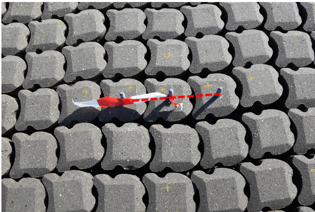
Fig. A-21, Foto van proeflocatie 7 'Hydroblocks matig' (rode stippellijn verbindt de getrokken stenen).
