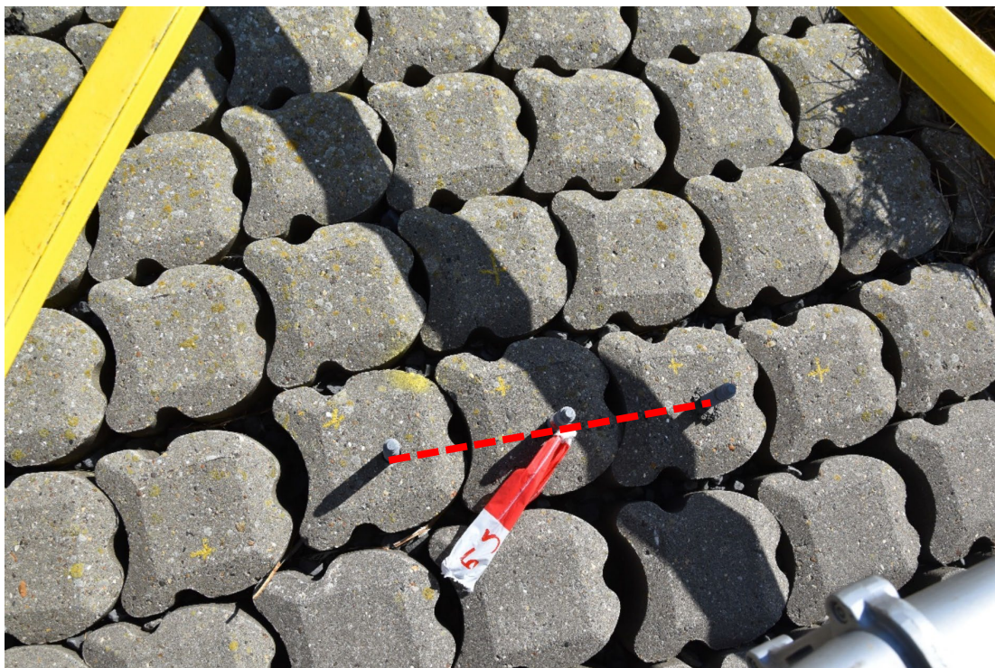
Fig. A-19, Foto van proeflocatie 5 'Hydroblocks matig' (rode stippellijn verbindt de getrokken stenen).
