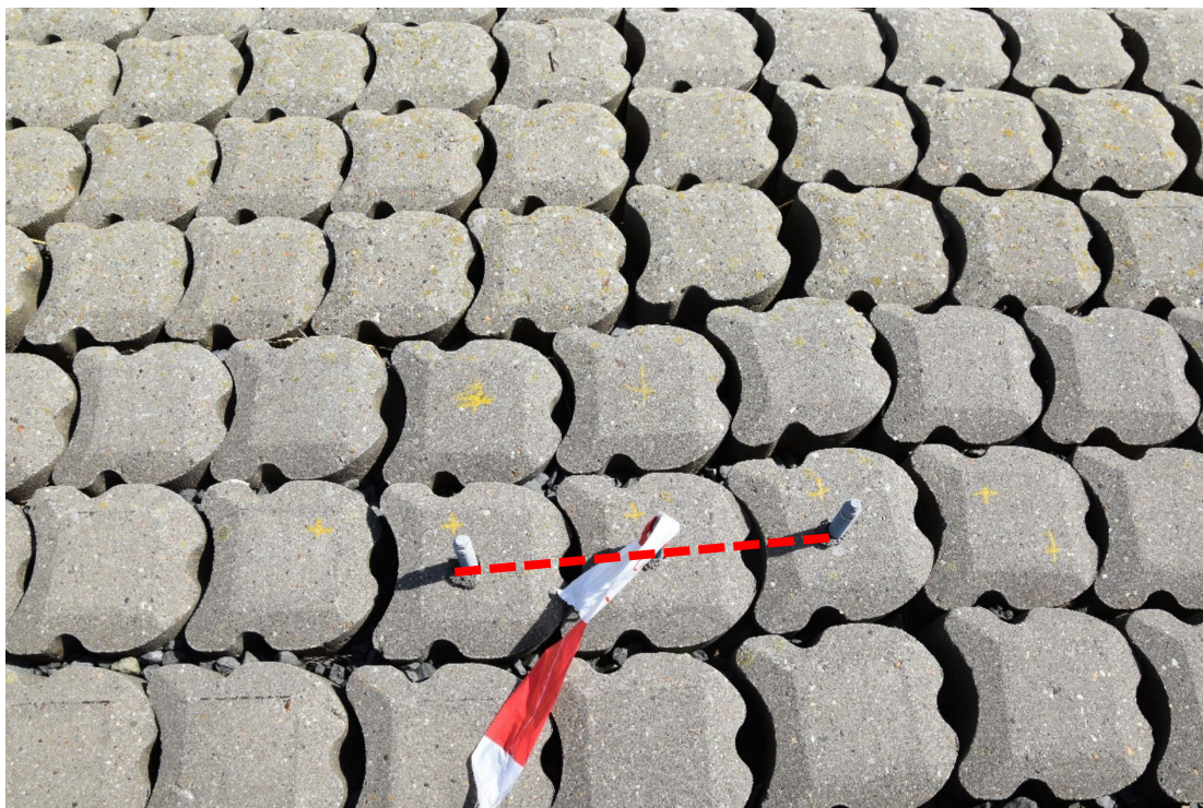
Fig. A-15, Foto van proeflocatie 1 'Hydroblocks matig' (rode stippellijn verbindt de getrokken stenen).
