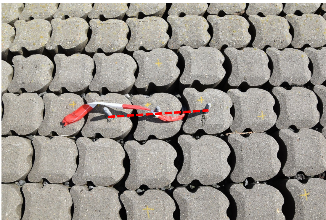
Fig. A-16, Foto van proeflocatie 2 'Hydroblocks matig' (rode stippellijn verbindt de getrokken stenen).
