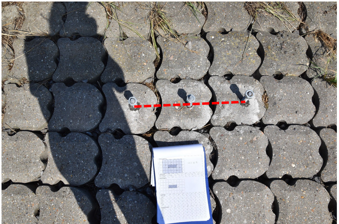
Fig. A-14, Foto van proeflocatie 3 'Hydroblocks goed' (rode stippellijn verbindt de getrokken stenen).
