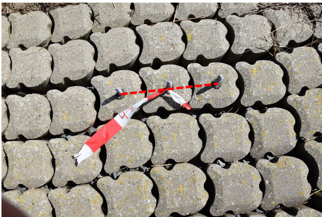
Fig. A-18, Foto van proeflocatie 4 'Hydroblocks matig' (rode stippellijn verbindt de getrokken stenen).
