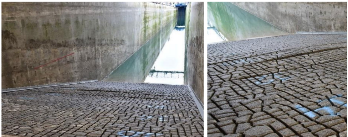
Figuur 2-4, Voorbeeld van een kattenrug, waarbij een heel rijtje zetstenen wordt opgelicht (Deltares, 2022b).
