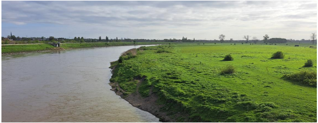
Figuur B.4 Zicht op de Gemeenschappelijke Maas vanaf de Pater Sangersbrug in noordelijke richting met aan de rechter zijde de af te graven oever (Roosteren I) (foto N. Asselman)
