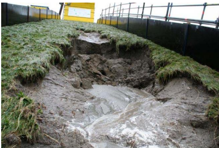
Foto 3.8 Erosie zandkern nadat zode en kleilaag zijn verdwenen
