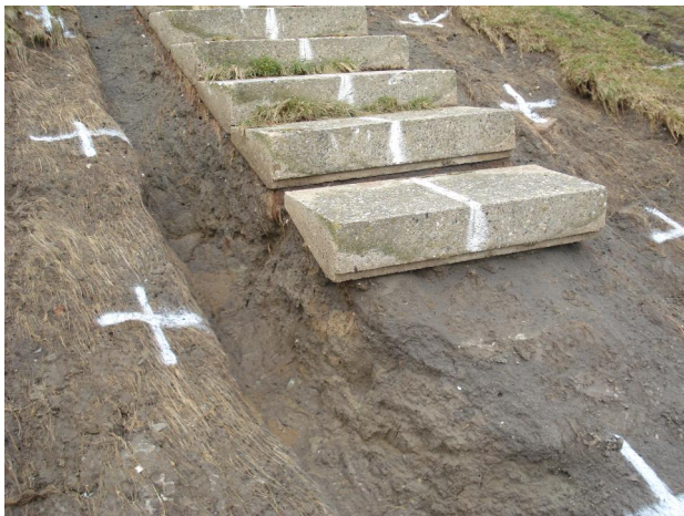
Foto 3.6 Erosie naast een taludtrap en verdwenen traptreden
