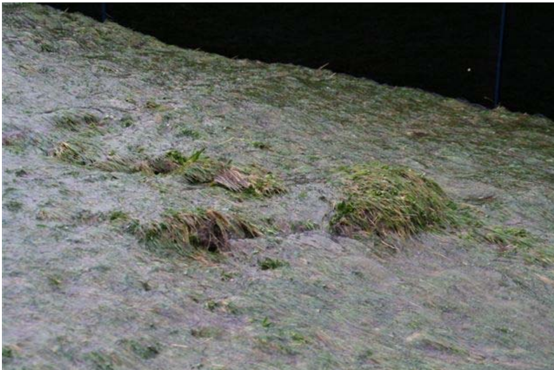
Figuur 41. Boonweg. Sectie 4. Begin van schade (opbolmechanisme) aan het talud.
