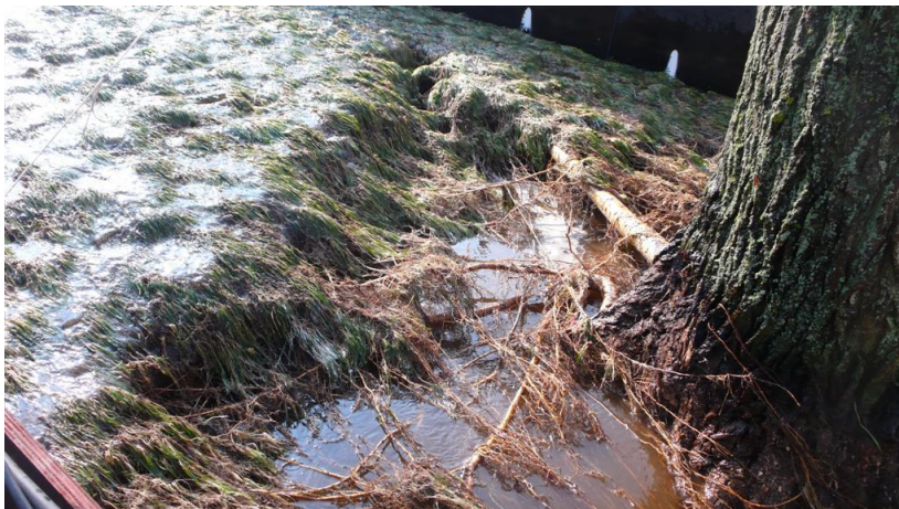
Foto 3.4 Ondermijning bovenstrooms talud door uitspoelen zand
