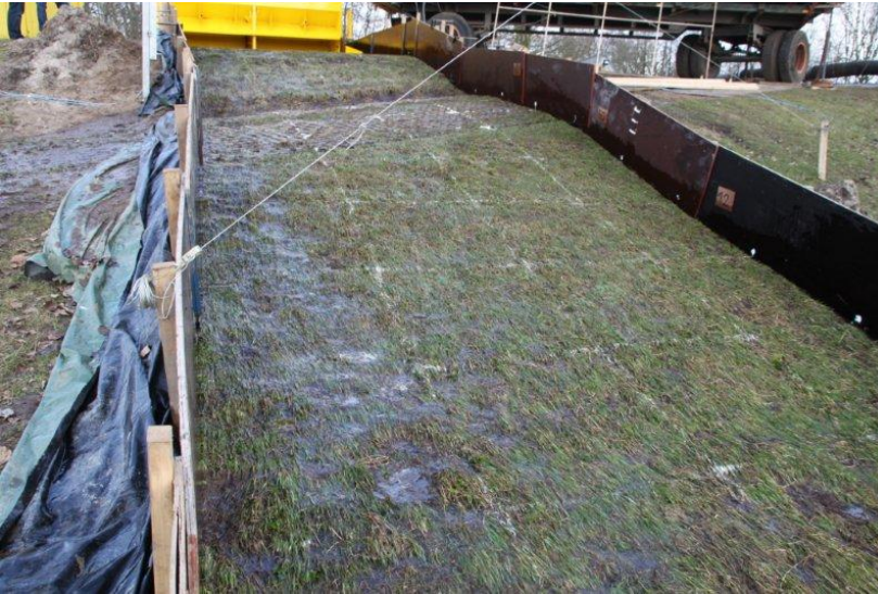
Foto 9. Vechtdijk. Zeeregime met overgang, proef 1; Meerdere locaties kale plekken talud.
