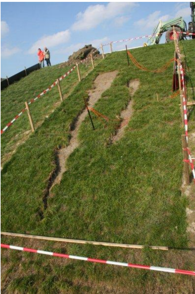
Foto 37. Delfzijl. Grastalud. Afstropen van het gras beneden de initiële schade.
