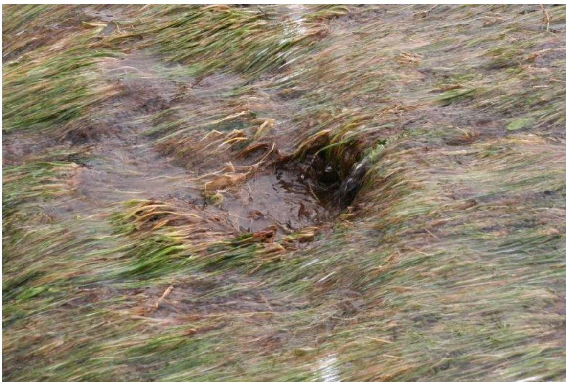
Foto 14. Vechtdijk. Zeeregime met boom, proef 2; Eerste schade aan talud.
