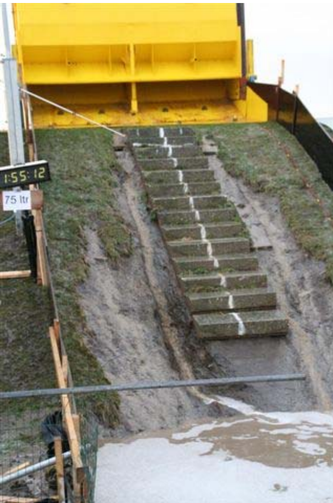
Figuur 58. Afsluitdijk. Sectie 3. Bezwijken van de trap.
