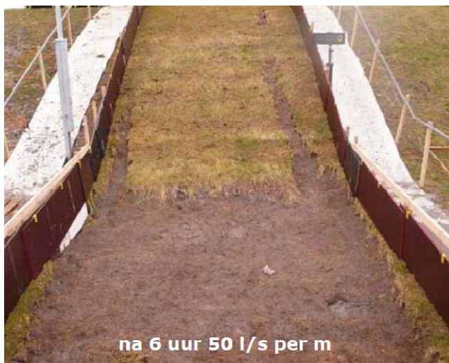
Figuur 52. Afsluitdijk. Sectie 1. Meerdere kale plekken op talud en gras verdwenen bij teen.
