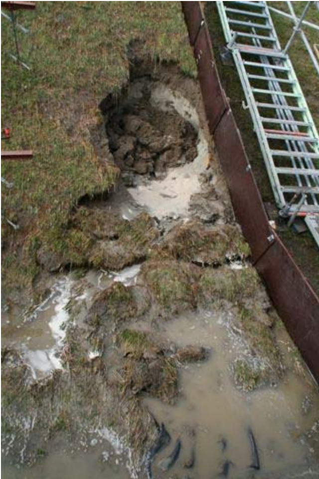
Figuur 44. St Philipsland. Talud bezweken en ook de reeds afgedekte teen.
