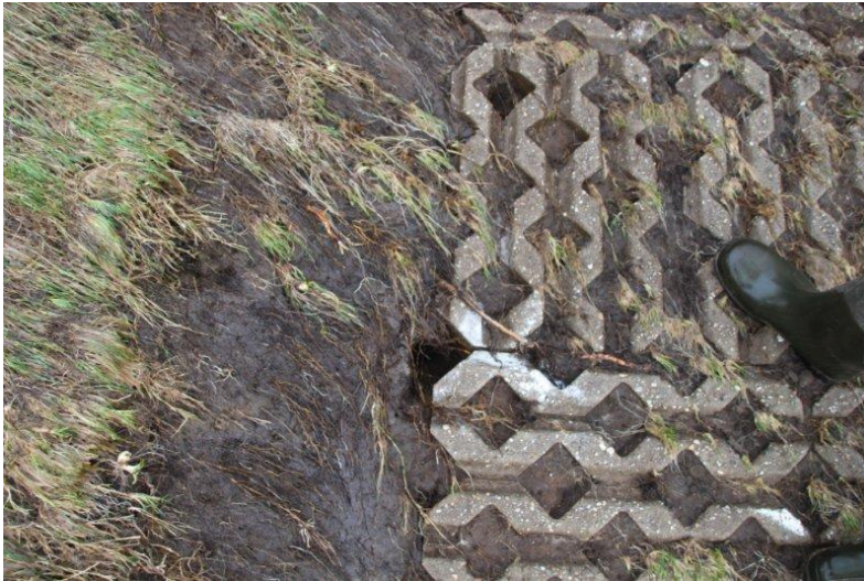
Foto 11. Vechtdijk. Zeeregime met overgang, proef 1; Begin ondermijning van de overgang.
