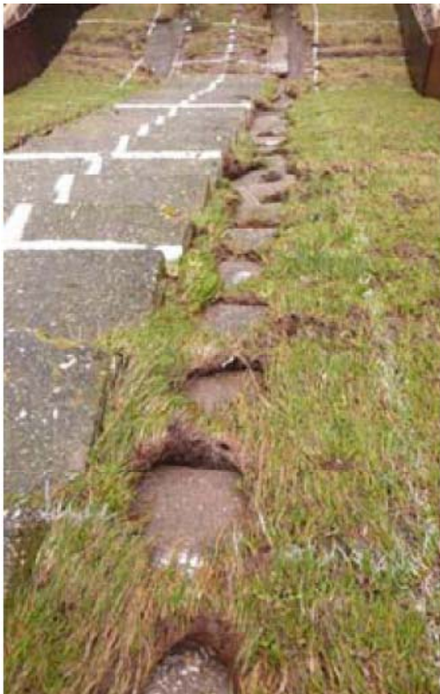
Figuur 56. Afsluitdijk. Sectie 3. Begin van schade aan de teen.
