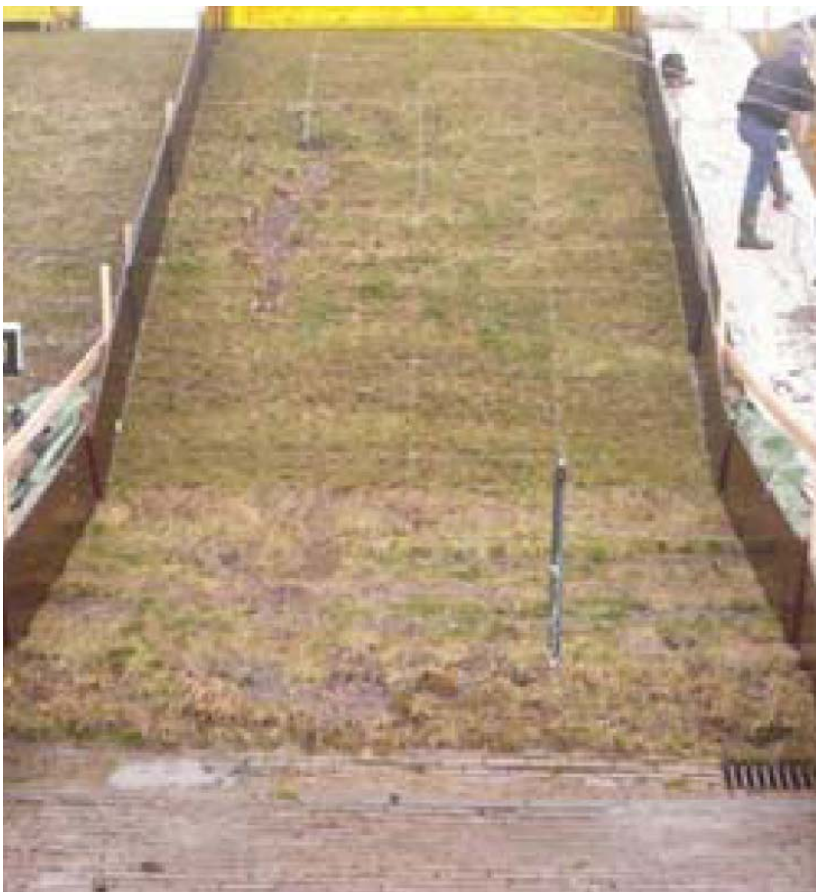
Figuur 54. Afsluitdijk. Sectie 2. Grotere/meerdere kale plekken op talud. Begin schade teen.
