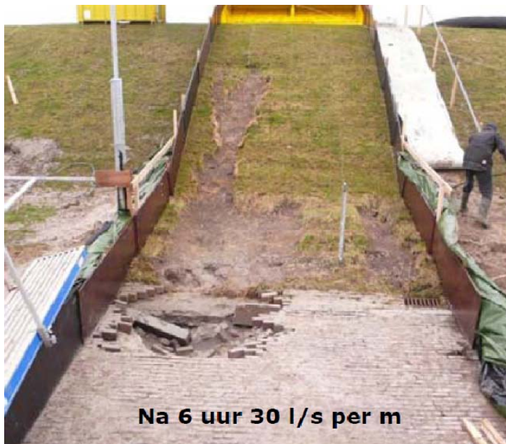
Figuur 55. Afsluitdijk. Sectie 2. Bezwijken van de klinkerbestrating op zand.
