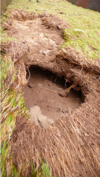
Foto 3.5 Strook 3 erosie en ondermijning talud zand
