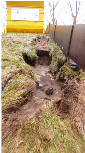
Ontstane schade als gevolg van instorten toplaag door uitspoeling
