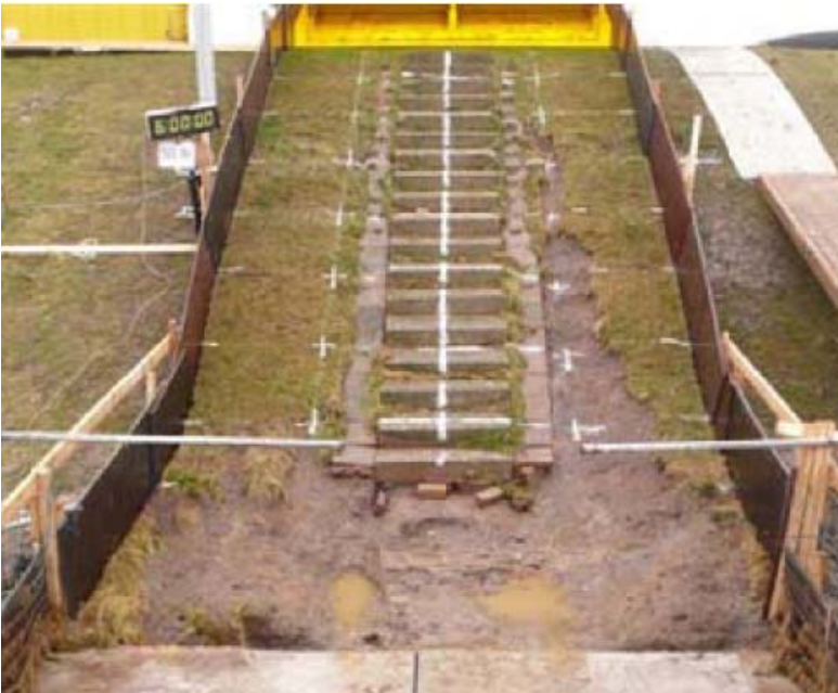
Figuur 57. Afsluitdijk. Sectie 3. Meerdere/grotere kale plekken op het talud.
