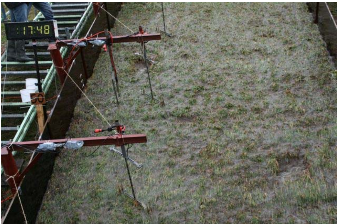
Figuur 43. St Philipsland. Begin van schade aan het talud (twee plekken)
