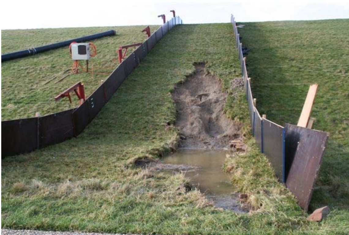
Figuur 40. Boonweg. Sectie 3. Na de proef, schade aan het talud en aan de teen.
