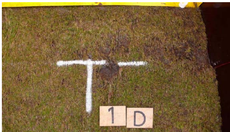
Figuur 51. Afsluitdijk. Sectie 1. Begin van schade aan het talud.
