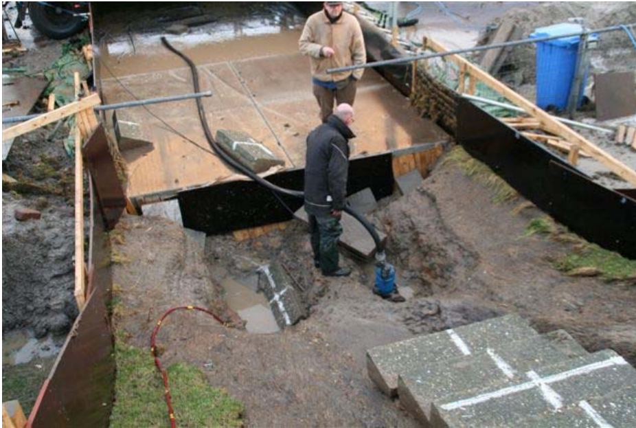
Figuur 59. Afsluitdijk. Sectie 3. Erosiekuilen, 1,0 m diep door stroomconcentratie langs de trap.
