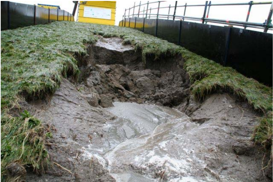
Figuur 42. Boonweg. Sectie 4. Na de proef, bezweken talud en geen schade aan de teen.
