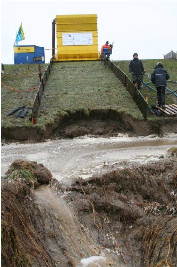
Figuur 46. Kattendijke. Sectie 1. Aan het einde van de proef. Geen schade aan het talud, bezwijken van teen met onderhoudsweg, leidende tot headcut erosie op het talud.
