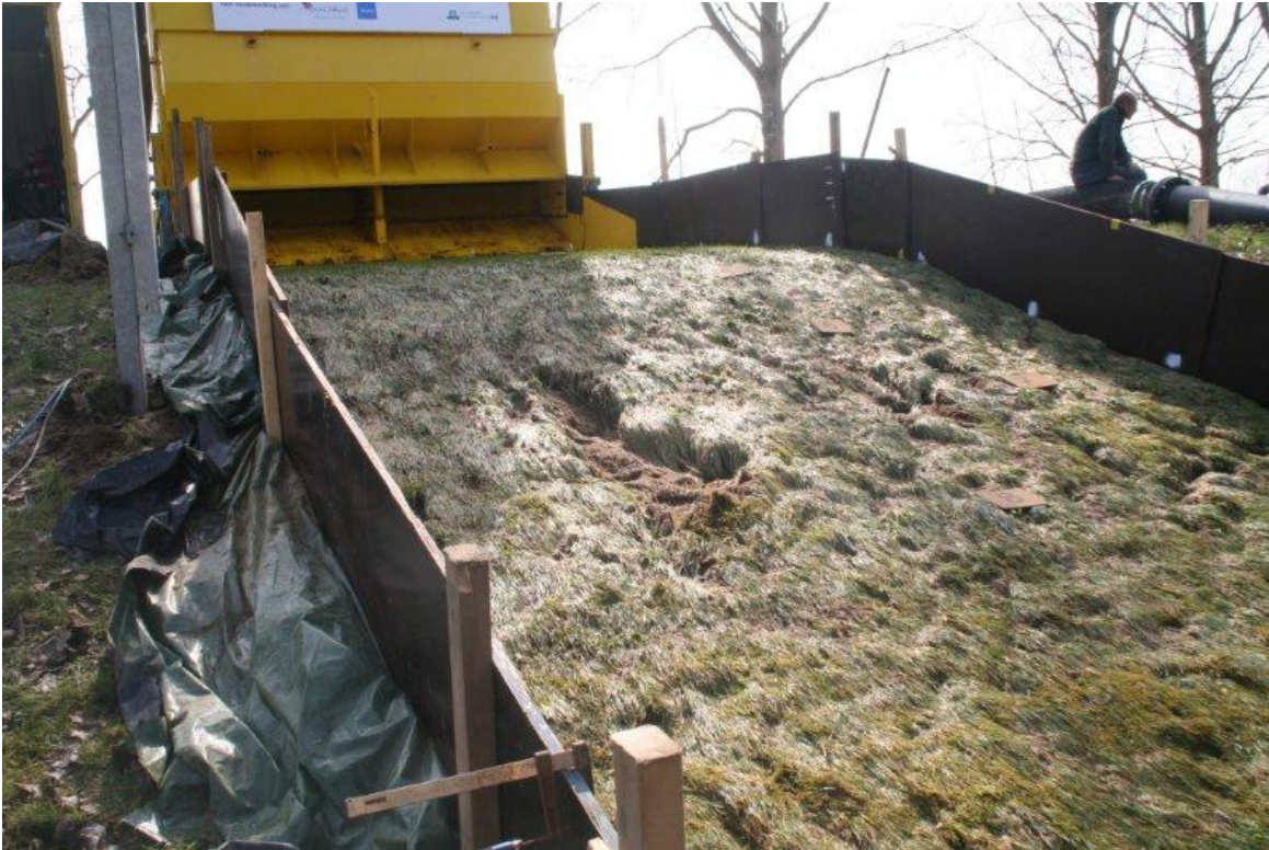
Foto 21. Vechtdijk. Zeer zwaar zeeregime, proef 3; Eerste schade talud.
