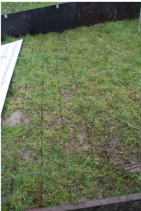
Figuur 47. Kattendijke. Sectie 2. Initiële schade door mestinjecteur op benedentalud.
