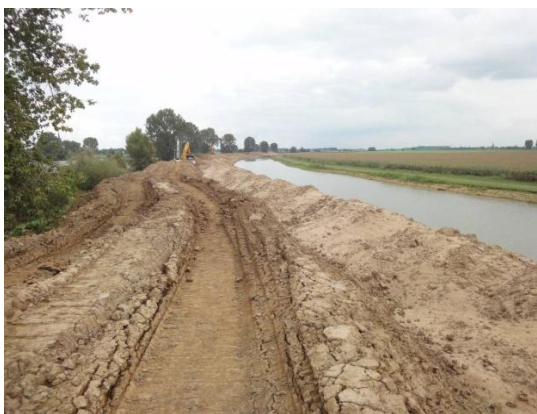
Figuur 3.50 Werkzaamheden aan de oostelijke oevergeul in de Ossenkamp in 2011 (foto Bart Peters).
