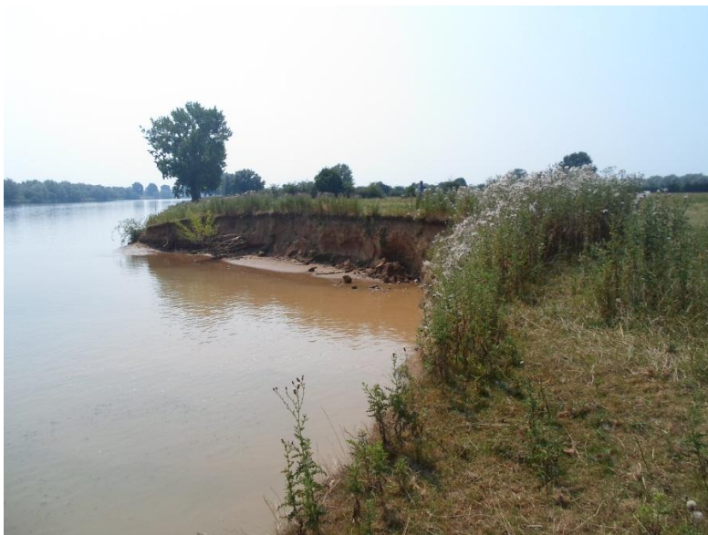
Erosieboog in de Maasoever bij Beugen Maaseiland (2013)
