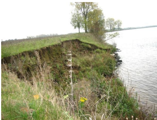
Voortschrijdende oevererosie op de locaties waar stenen zijn verwijderd (F. Kerkum 2014).
