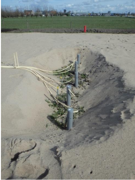
Figuur 3.5 De waterspanningsmeters tussen het drainagezand
