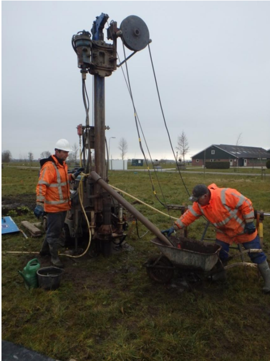
Figuur 4.4 Boorstelling bezig met het uitvoeren van een Ackermann puls boring. De Ackermann bussen worden gedrukt in het slappe lagen pakket (15-3-2016)
