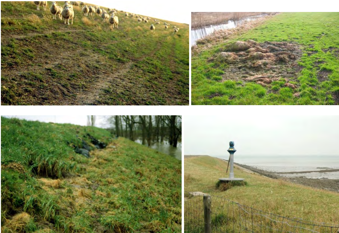
Figuur 4.8 Ongewenste beschadigingen van het gras en slecht gras onder de staander, die een te grote onderbreking is van de grasmat
