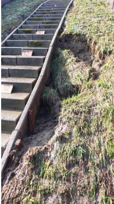
Figuur 6.1 Schade als gevolg van stroomconcentratie in combinatie met verminderde sterkte door onder andere het gebruik van onkruidwerend middel langs de trap (Golfoverslagproef op dijk bij Poortvliet, Tholen, na 2 uur 5 l/s per m)
