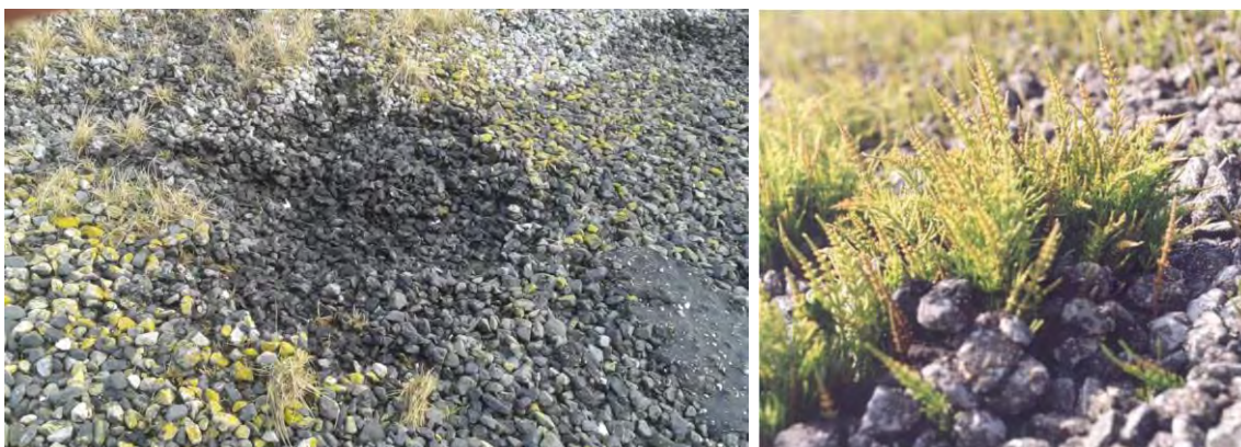
Figuur 3.5 Aangetast oppervlak van opensteenafalt (links) en ongewenste vegetatie van Heermoes op opensteenafalt (rechts) (Koac-NPC 2014)
