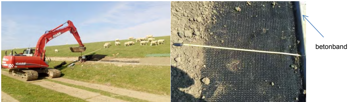
Figuur 4.24 Links: het plaatsen van de betonbanden op de Robulon. Rechts: Impressie van het textiel na aanleg (hierna is er nog 5 cm teelaarde op geplaatst).
