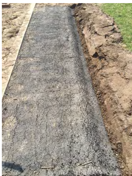
Figuur 4.20 Impressie van de Enkamat na aanleg. De sleuf aan de rechterzijde van de foto dient nog toegedekt te worden. Na aanleg is er nog 2 cm teelaarde overheen gestrooid.
