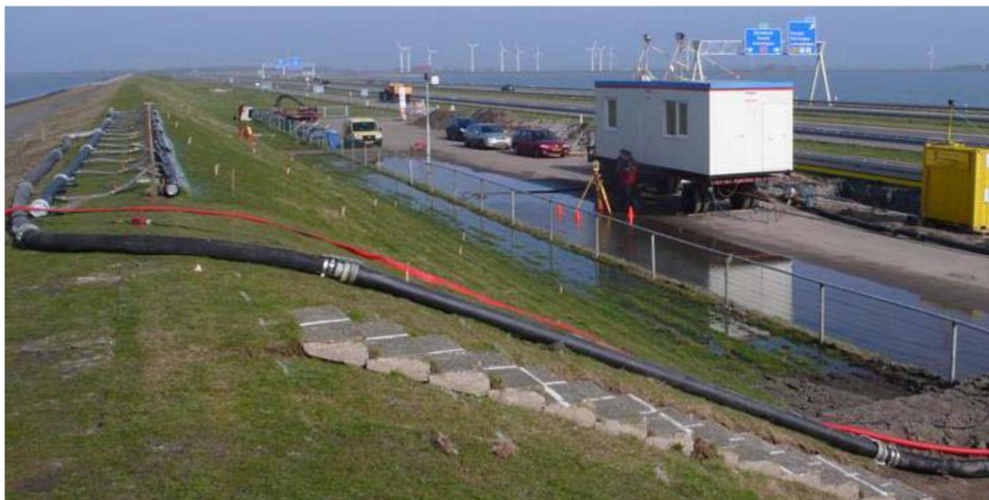
Figuur E.2 Voorbeeld infiltratie van water binnentalud Afsluitdijk, links op de kruin van geperforeerde buis, onderaan het talud de meetkeet
