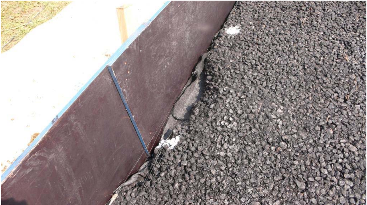
Foto F-19 Daar waar bij de proeven met 125 l/s per m op Elastocoast® geen schade was opgetreden is bij de proeven op het open steenasfalt op enkele plekken schade aan de randen geconstateerd. Deze schade was een gevolg van slechte randafwerking door de aannemer en heeft uiteindelijk niet geleid tot schade bij de grote overslagdebieten.
