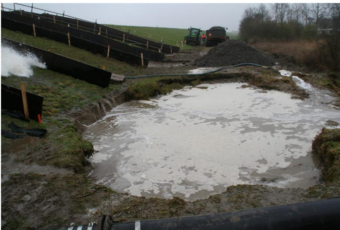
Figuur 8-4 Schade aan de onderhoudsweg
