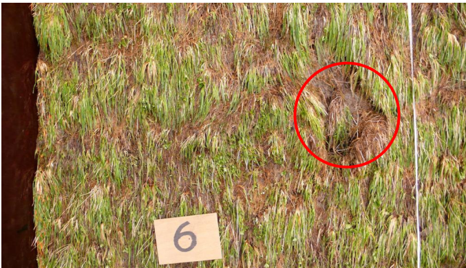
Figuur 7-1 Aandachtsplekken op het talud
