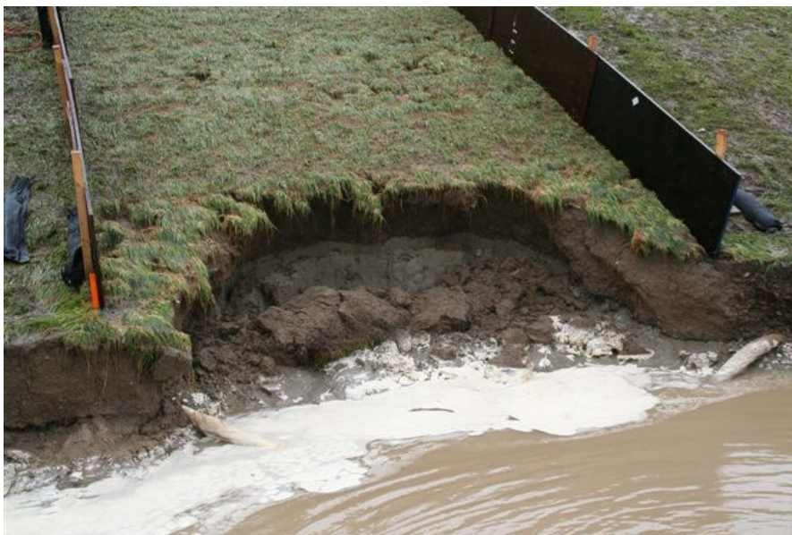
Figuur 4.4 Begin van headcut erosie; Kattendijke proefvak 1
