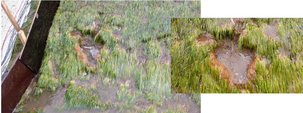
Figuur 9-1 Erosie linksonder op het talud
