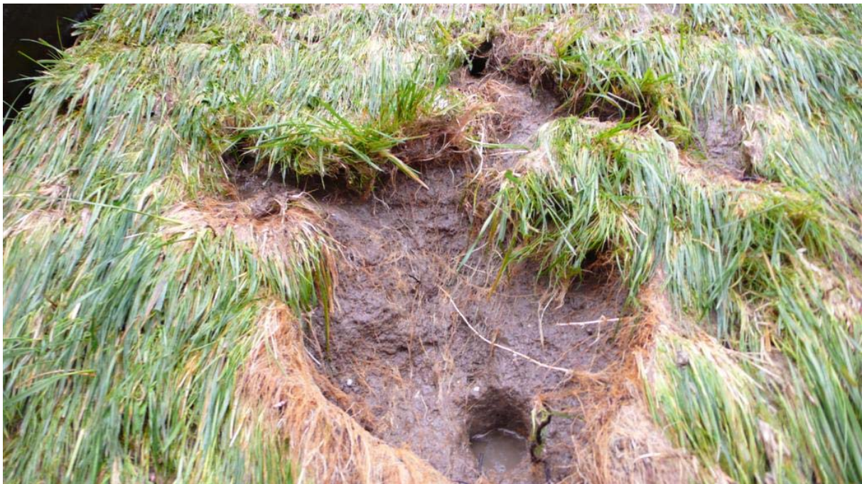
Foto F-14 Gedurende de proeven met 30 l/s per m ontstond links onder aan het talud, net boven de teen en ter plaatse van de eerste injectorsnede een gat dat langzaam in omvang toenam.
