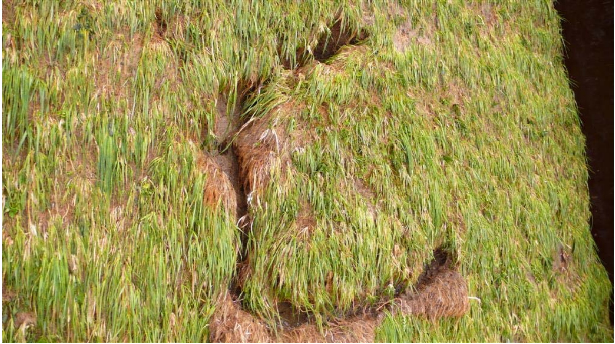
Foto F-16 Ondanks het feit dat klei onder de moot erodeerde, zat de moot voldoende vast om er niet door de golven uitgeslagen te worden. De moot zakte uiteindelijk na erosie van de klei weer langzaam in en stroomde het water weer over het talud zonder verder schade te veroorzaken.
