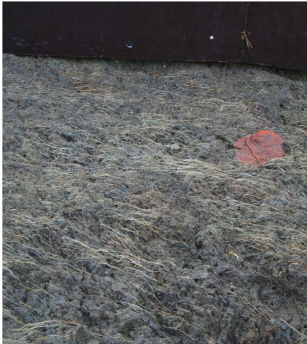
Figuur 9: wortelstructuren bovenstrooms van schadelocatie
