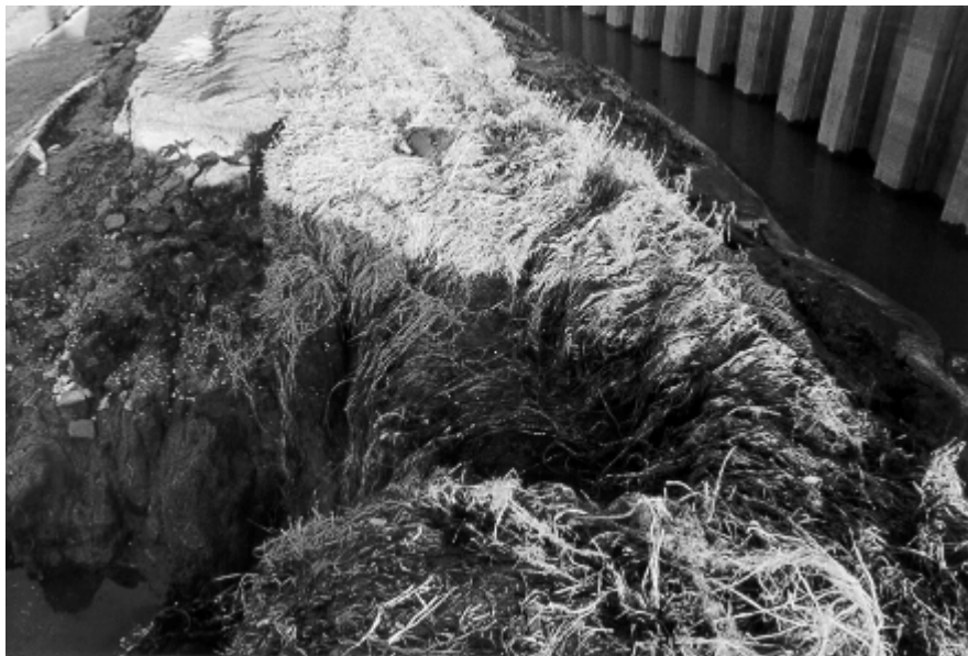
Bres met oude, diepgaande, verticale scheuren zichtbaar.
