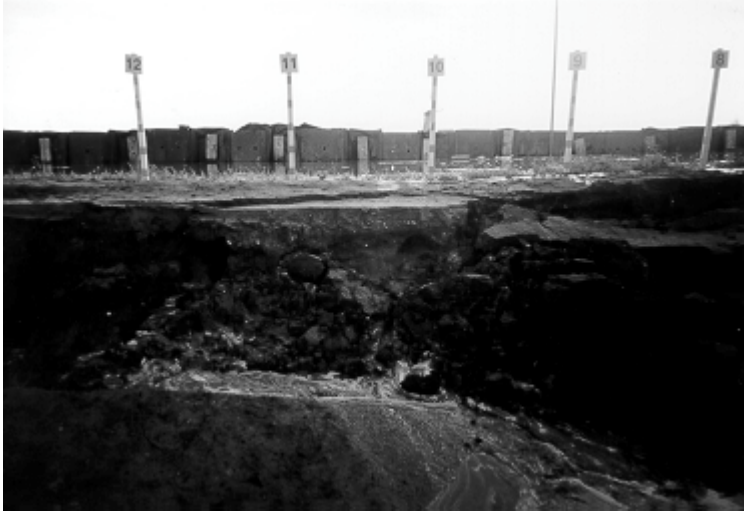
Begin van overlopen. Door de scheuren stroomt reeds water.
