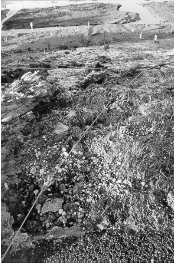
Geulen in het binnentalud.
