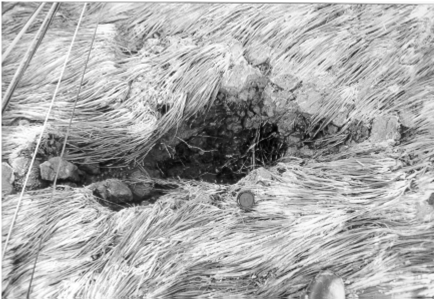
Gat ontstaan in grasbekleding.
