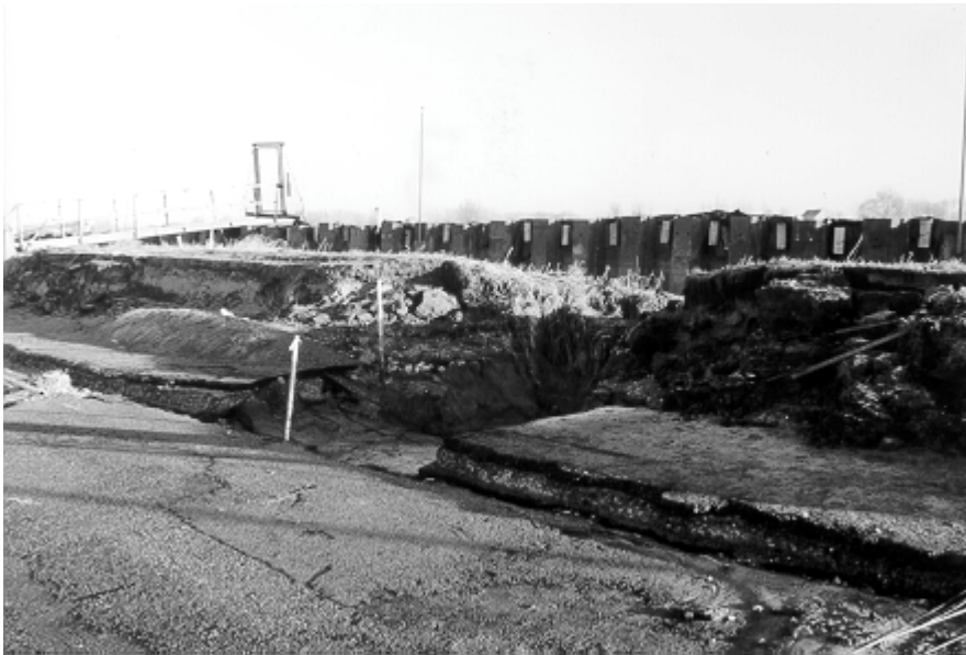
Situatie op zondag 9 december: de asfaltbrug is ingestort.
