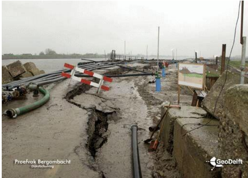
Kruin dijk na afschuiving, oostzijde proefvak
