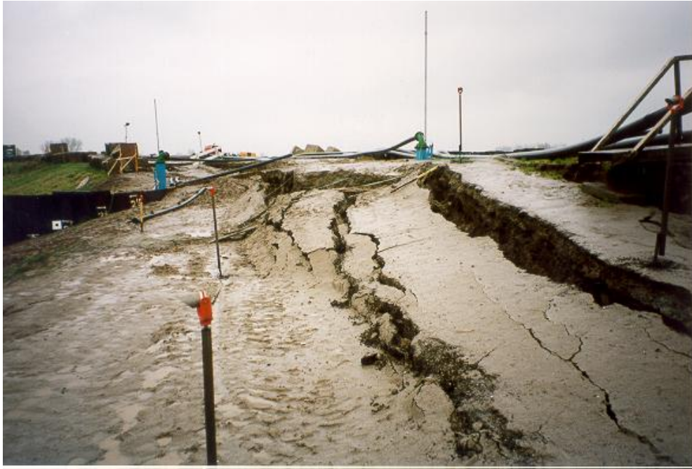
Detail scheurvorming in de kruin.
