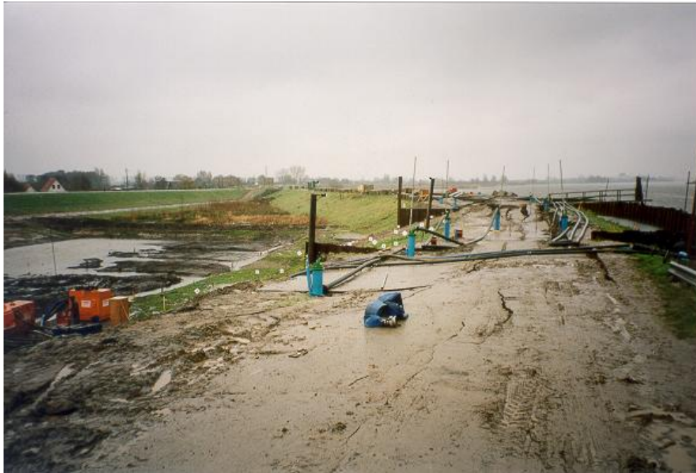
Kruin dijk na afschuiving vanaf de westzijde van het proefvak
