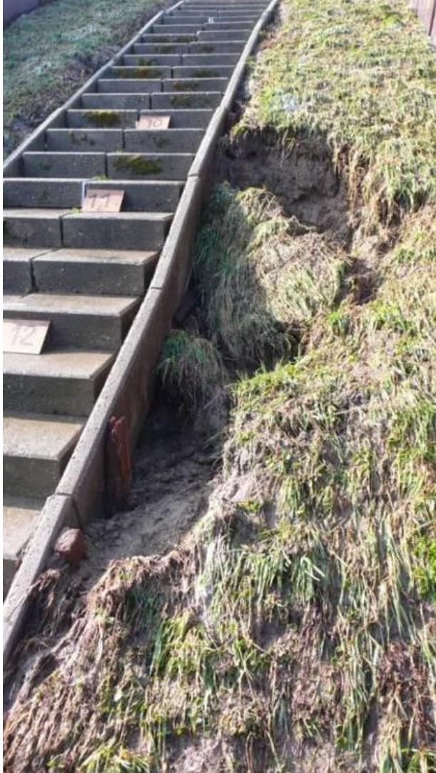
Figuur 8.3 Schade als gevolg van stroomconcentratie in combinatie met verminderde sterkte door onder andere het gebruik van onkruidwerend middel langs de trap (Golfoverslagproef op dijk bij Poortvliet, Tholen, na 2 uur 5 l/s per m)
