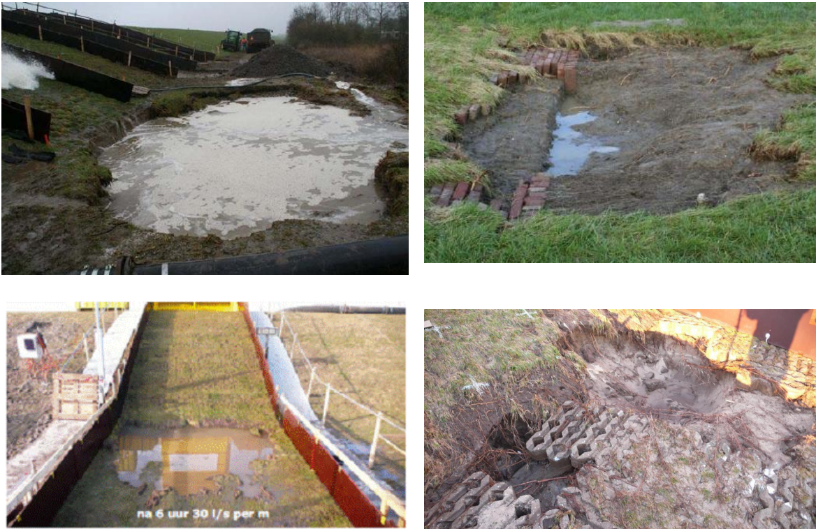
Figuur 5.4 Jet erosie bij de overgang van een talud naar horizontaal
