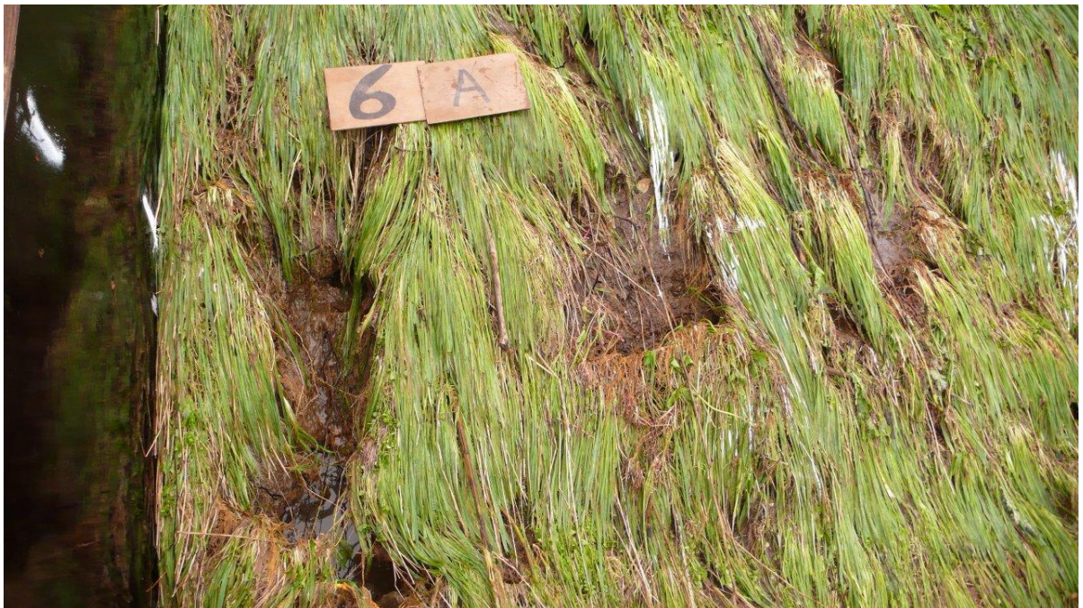
Figuur B73. Tielrode, België. Sectie 2. Meerdere plekken schade.
