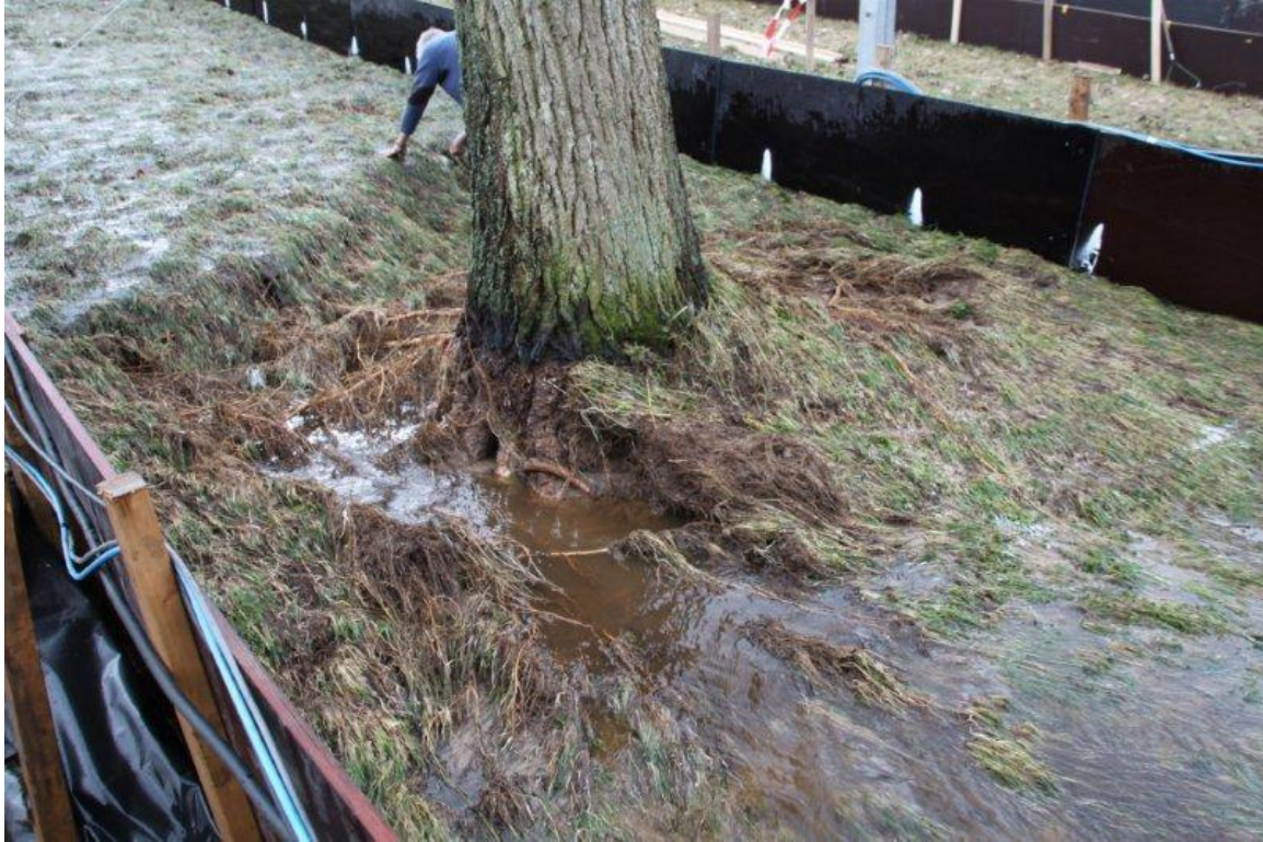
Foto B48. Vechtdijk. Zeeregime met boom, proef 2; Gestopt, headcut erosie bovenstrooms van boom.
