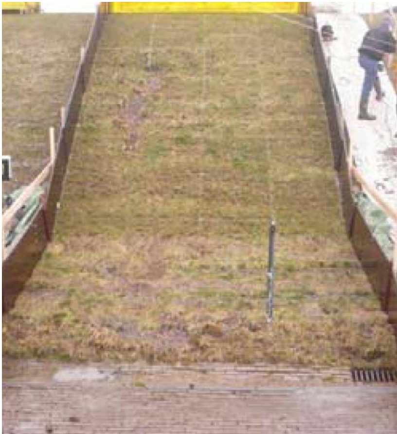
Foto B30. Afsluitdijk. Sectie 2. Grotere/meerdere kale plekken op talud. Begin schade teen.
