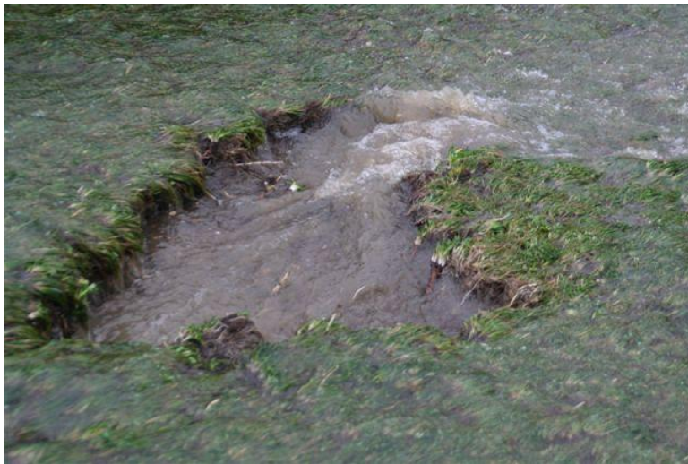
Foto B13. Boonweg, Friesland, sectie 4. Direct nadat de eerste opbolling was weggespoeld.
