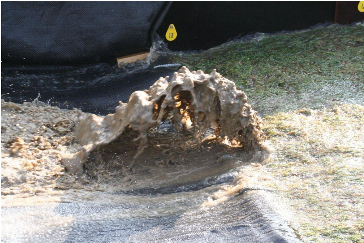
Figuur B98. Tholen, sectie 4, binnentalud. Verzakking talud veroorzaakt door zandmeevoerende wel.
