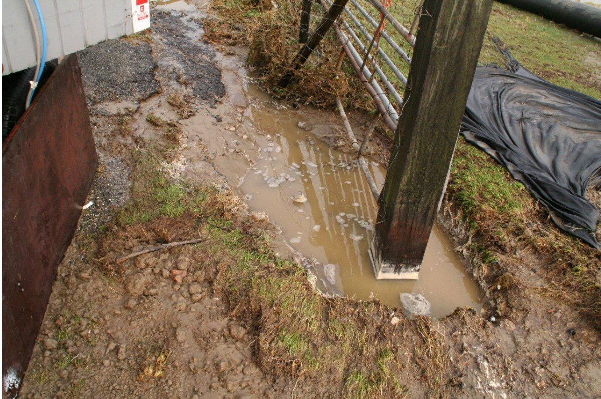
Figuur B94. Tholen. Sectie 3, afrastering. Einde proef, erosie rondom paal 0,2x0,2 m. Diepte: 0,65 m.
