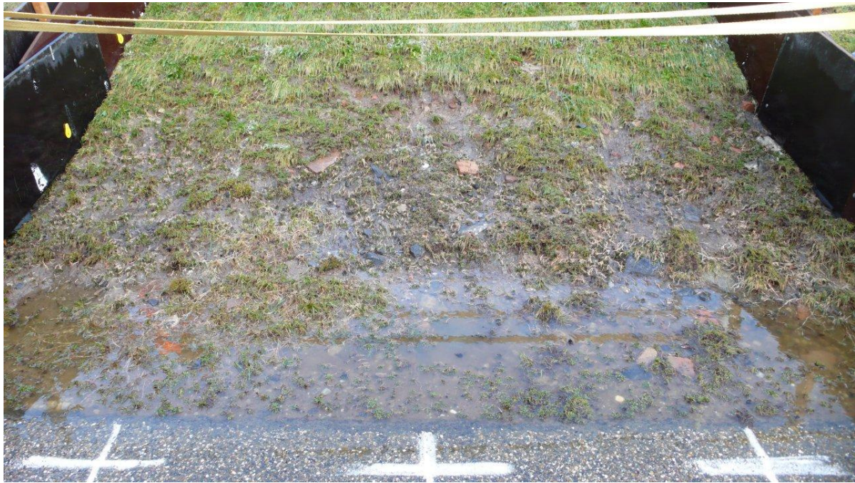
Figuur B104. Tholen, sectie A, oploop buitentalud. Na Ru_{2\%} op 0,8 m boven bermniveau.
