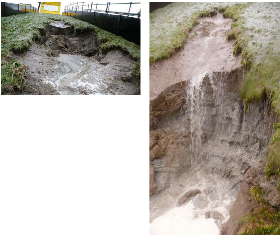
Figuur 5.7 Afbrokkelen van de bovenrand van een grasbekleding bij een zanddijk met een 0,6 m dikke kleilaag (Waddenzeedijk Friesland bij de Boonweg)
