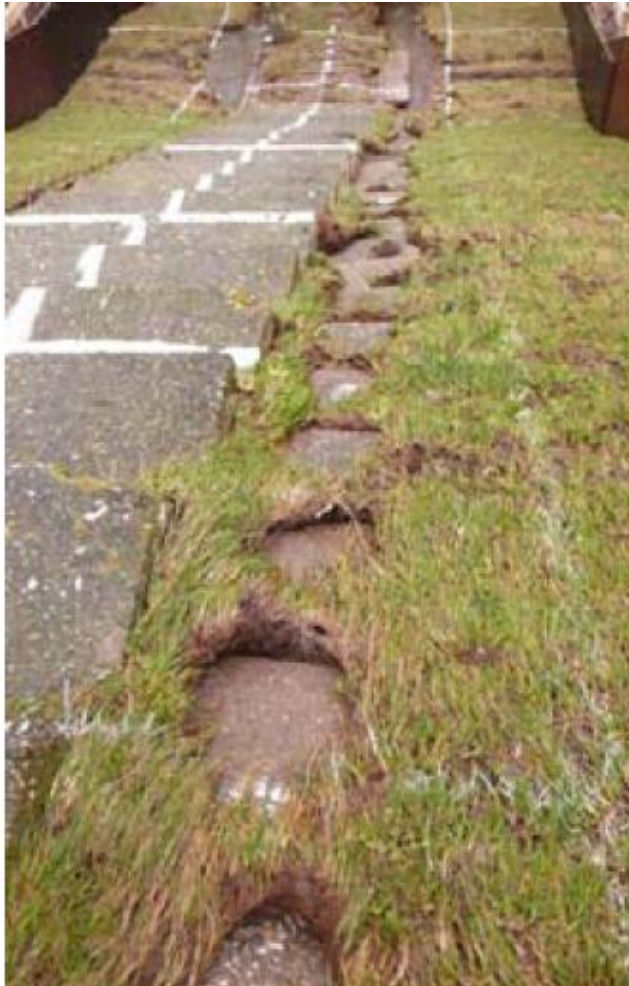
Foto B32. Afsluitdijk. Sectie 3. Begin van schade aan de teen.
