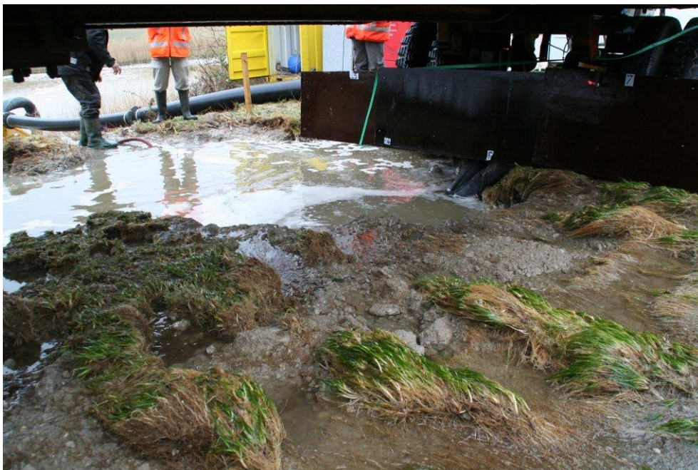
Foto B21. Kattendijke. Sectie 1. Schade aan teen voordat meetwagen moest worden verplaatst.
