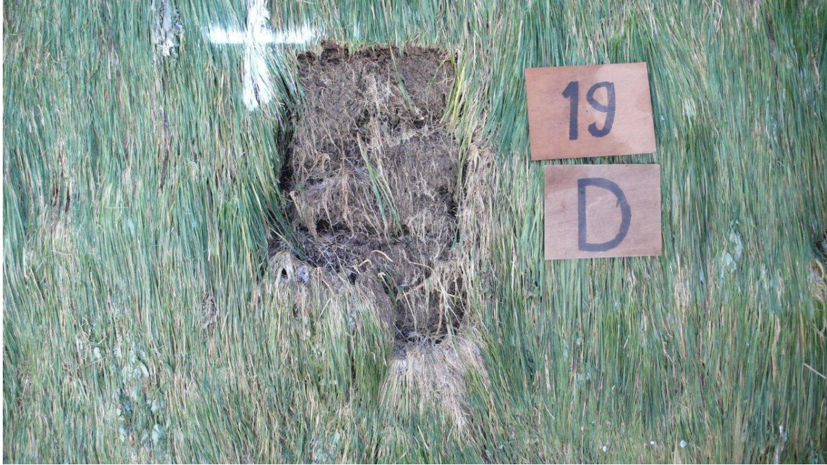
Figuur B67. Tielrode, België. Durmedijk. Na alle series. Geringe uitbreiding aangebrachte schade van 0,32x0,32 m en 0,02 m diep.
