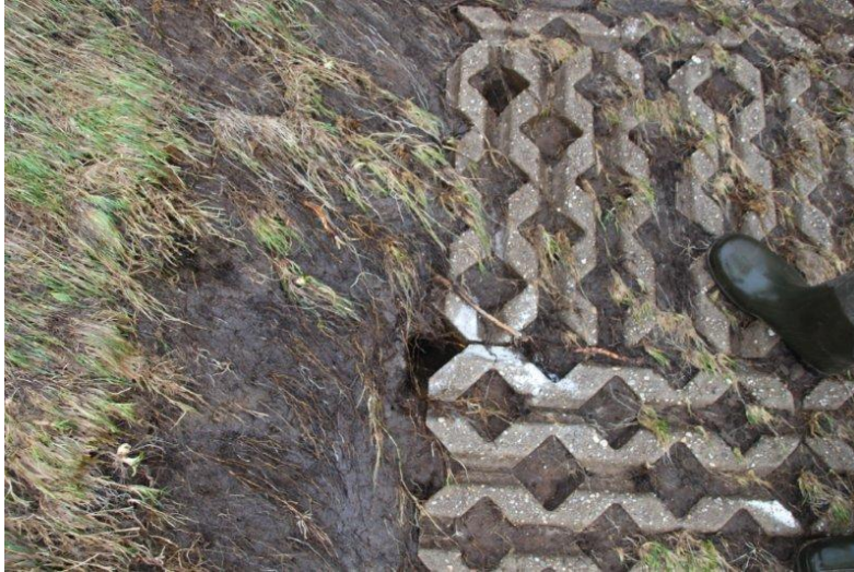
Foto B40. Vechtdijk. Zeeregime met dijkovergang, proef 1; Begin ondermijning van de overgang.
