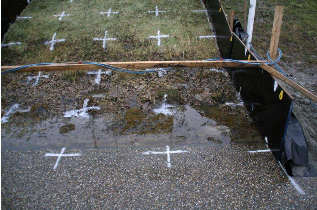
Figuur B78. Tholen. Sectie, buitentalud. Begin van schade open deel.
