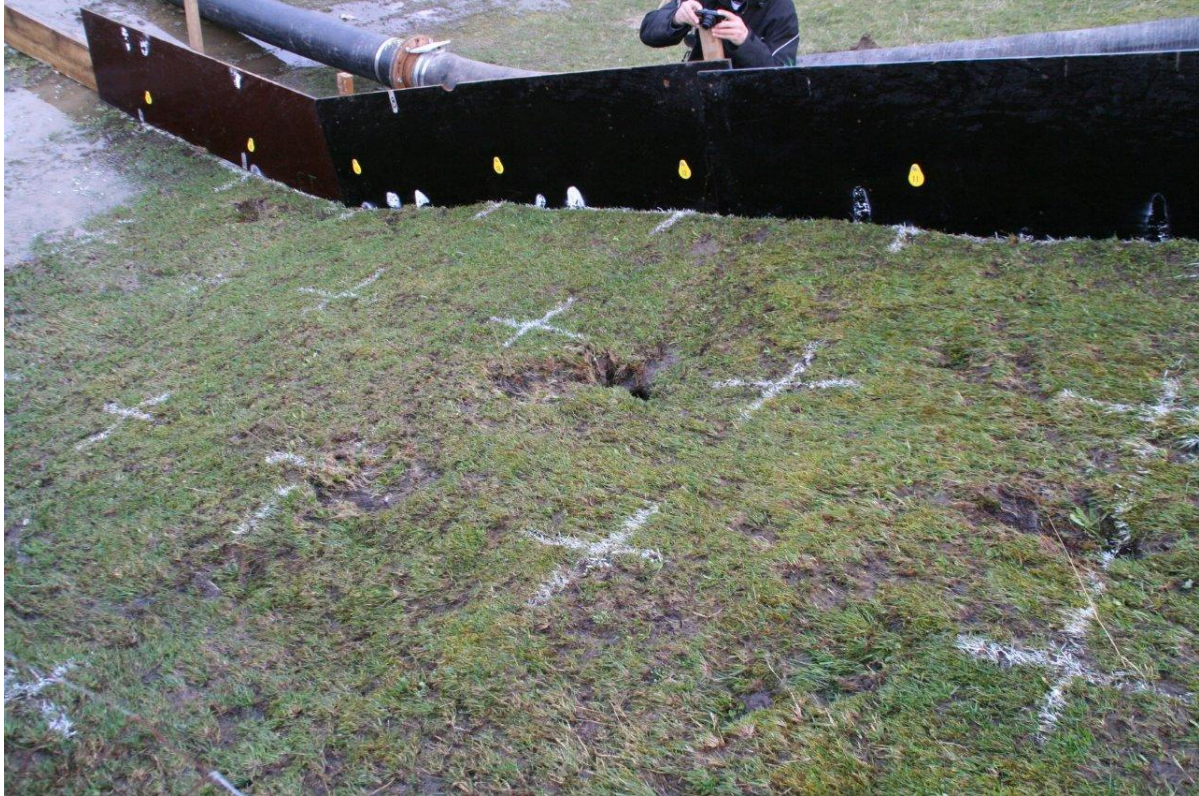
Figuur B87. Tholen. Sectie 3, afrastering. Meerdere plekken schade aan talud.
