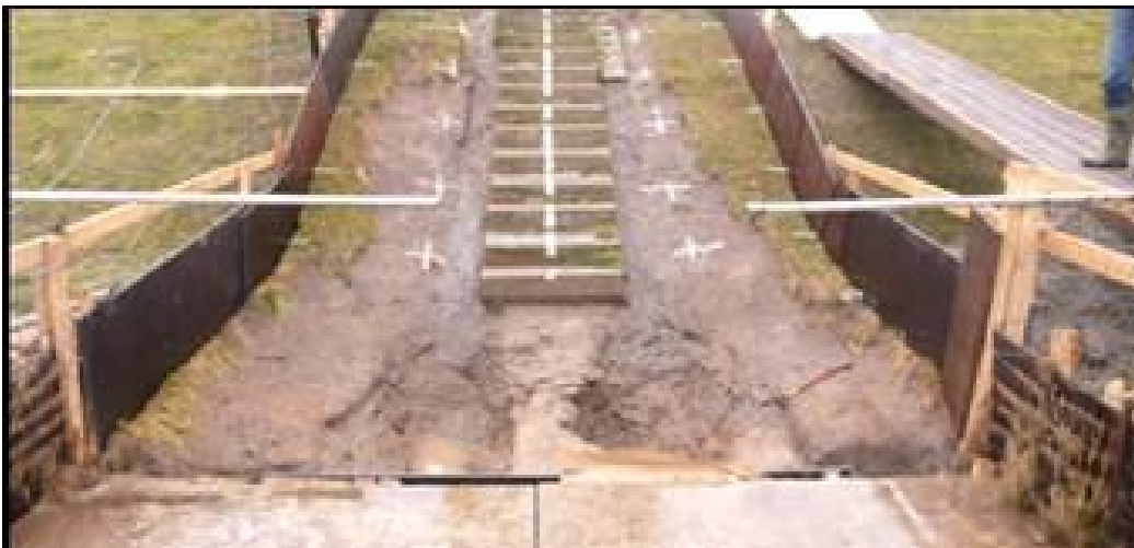
Figuur 8.2 Schade als gevolg van stroomconcentratie na zeer grote overslagdebieten (Golfoverslagproeven Afsluitdijk, 6 uur 50 l/s per m)
