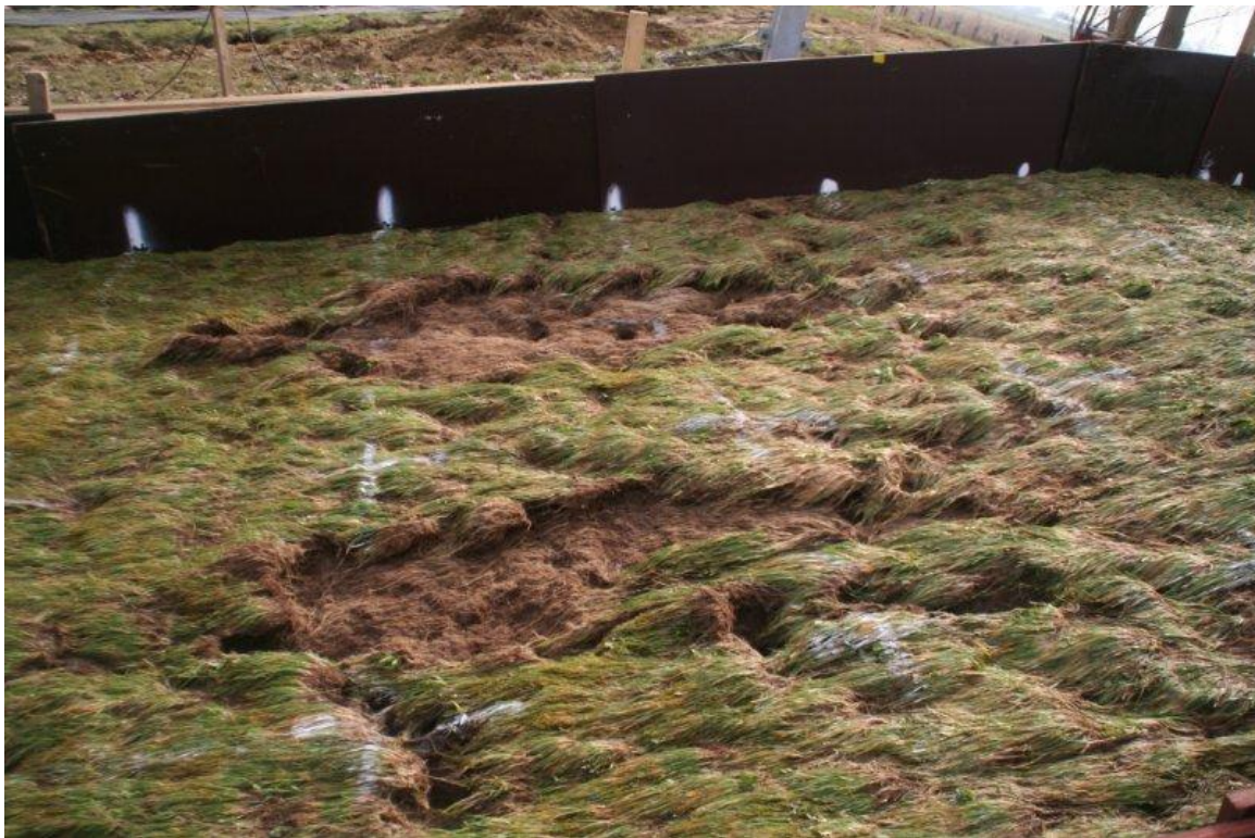
Foto B51. Vechtdijk. Zeer zwaar zeeregime, proef 3; Meerdere kale plekken talud.
