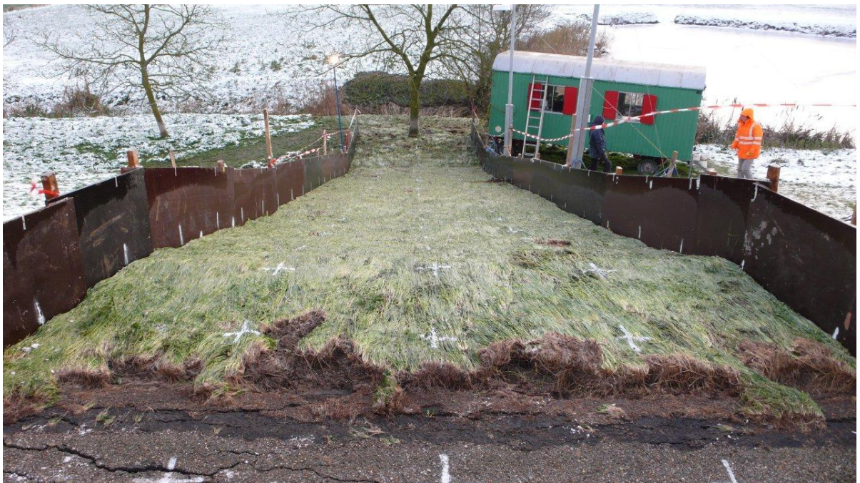
Figuur B66. Tielrode, België. Durmedijk. Na alle series. Geringe uitbreiding schade overgang asfaltkruin naar gras. Geen schade aan talud of boom.
