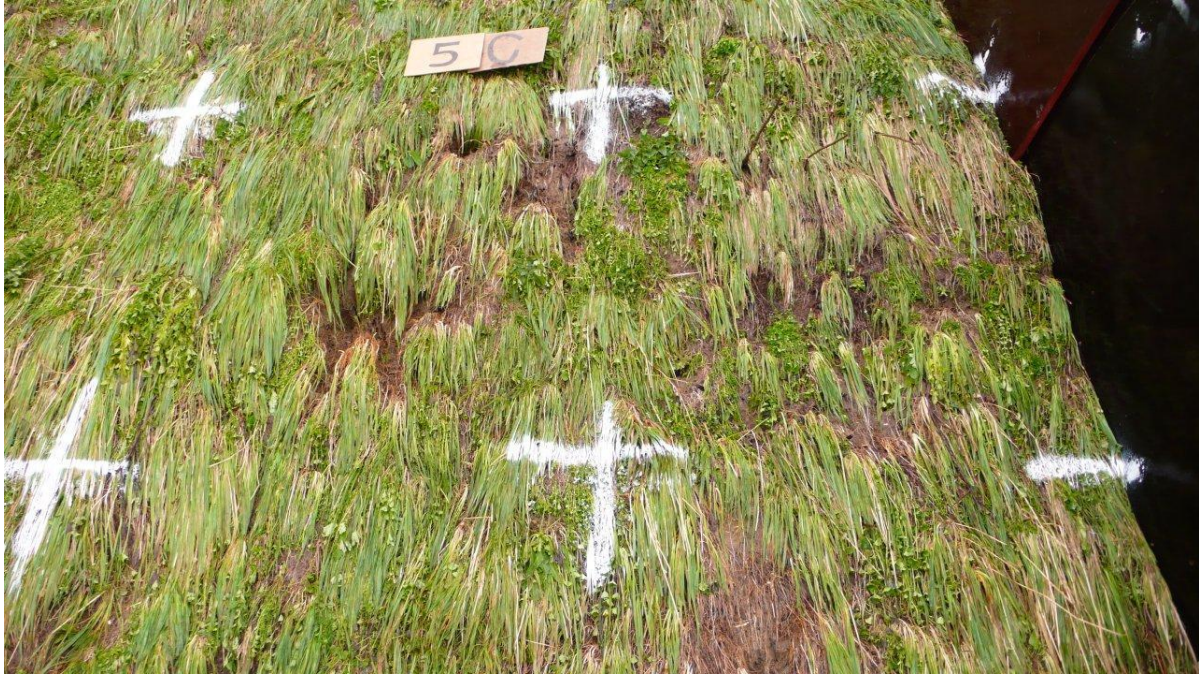
Figuur B76. Tielrode, België. Sectie 4. Meerdere plekken schade.
