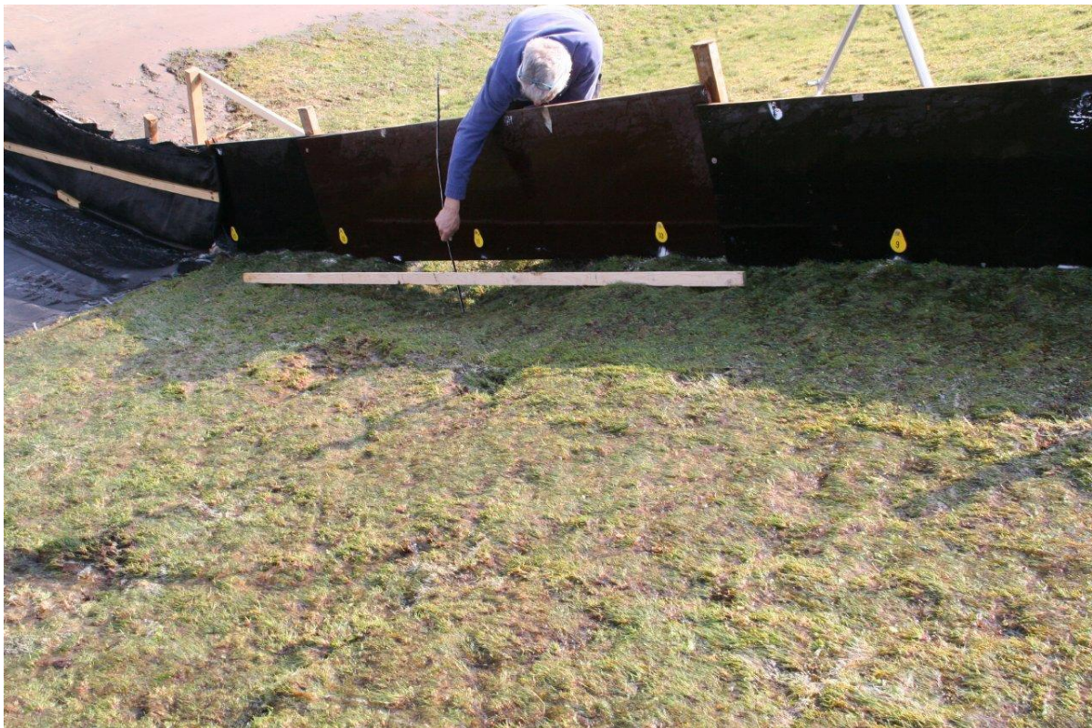
Figuur B97. Tholen, sectie 4, binnentalud. Verzakking talud.
