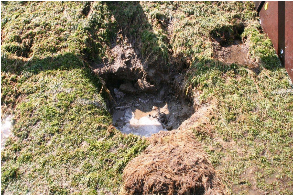
Figuur B101. Tholen, sectie 4, binnentalud. Bezweken teen.
