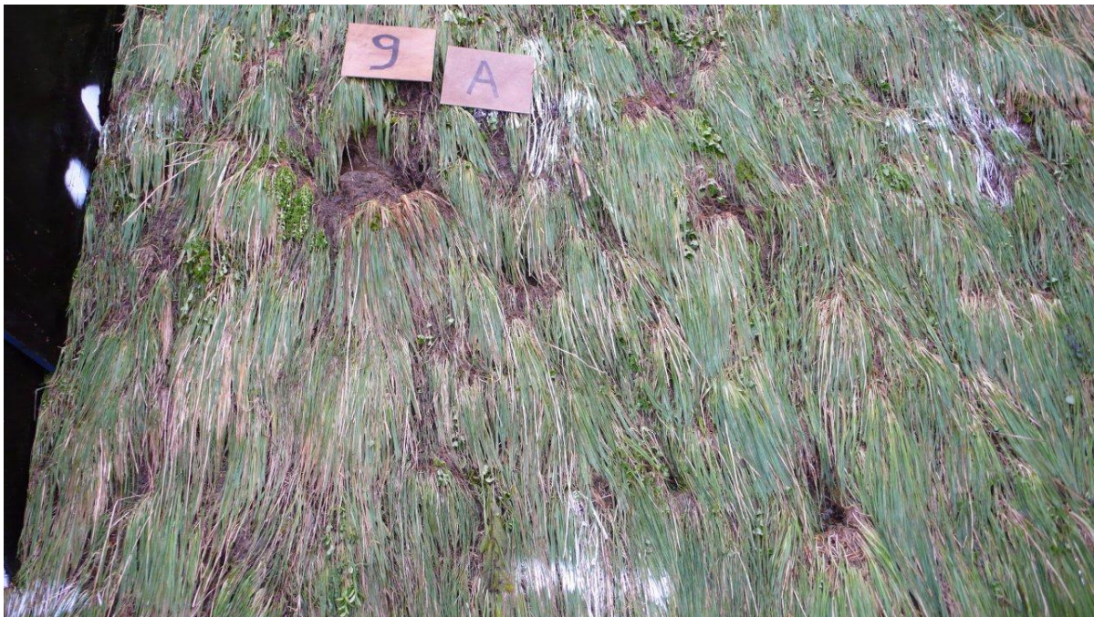
Figuur B75. Tielrode, België. Sectie 4. Begin schade.
