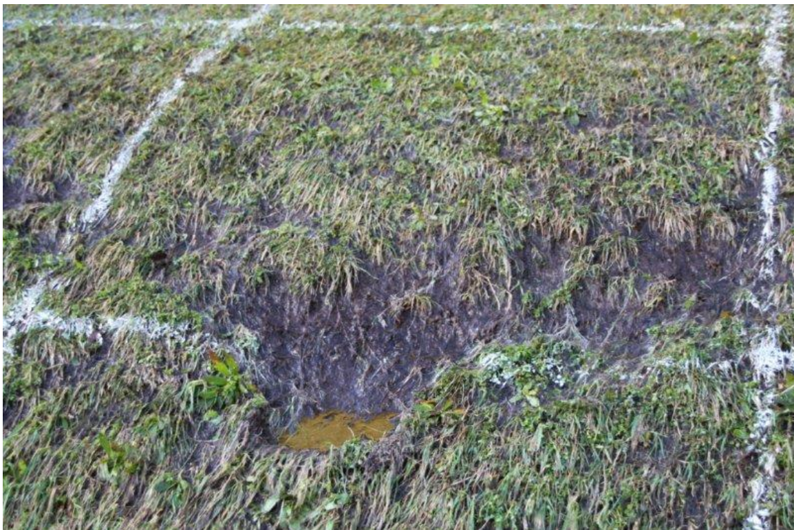
Foto B37. Vechtdijk. Zeeregime met dijkoevergang, proef 1; Eerste schade talud.
