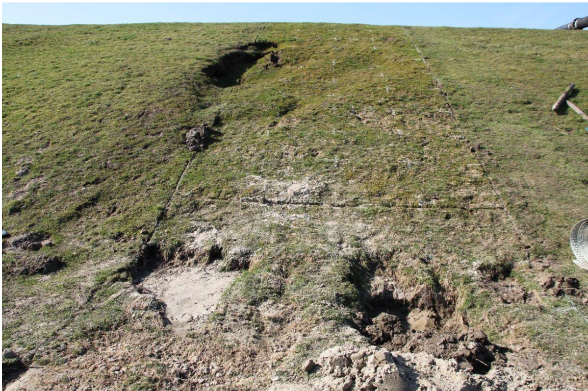
Figuur B99. Tholen, sectie 4, binnentalud. Bezweken talud (en teen - onderaan).
