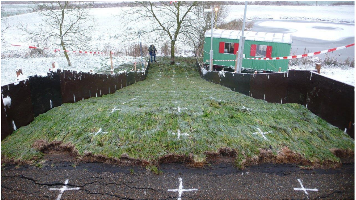
Figuur B65. Tielrode, België. Durmedijk. Na eerste serie. Begin schade overgang asfaltkruin naar gras. Geen schade aan talud of boom.
