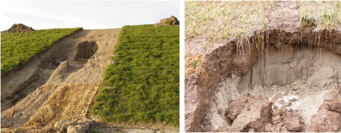
Figuur 5.6 Head cut erosie op een zeedijk van kale klei bij Delfzijl, beproefd met de golfoverslagsimulator na verwijderen van de toplaag (links). Head cut erosie bij zanddijk met kleibekleding Sint Philipsland (rechts)
