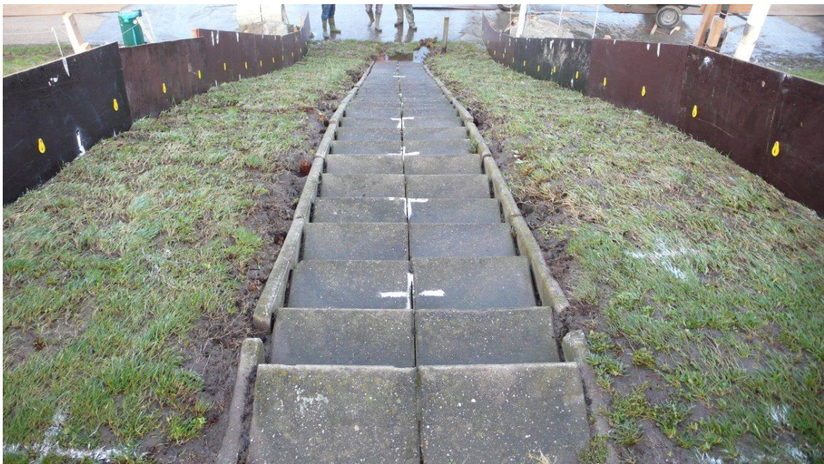
Figuur B81. Tholen. Sectie 2, trap. Meerdere plekken schade langs de trap.
