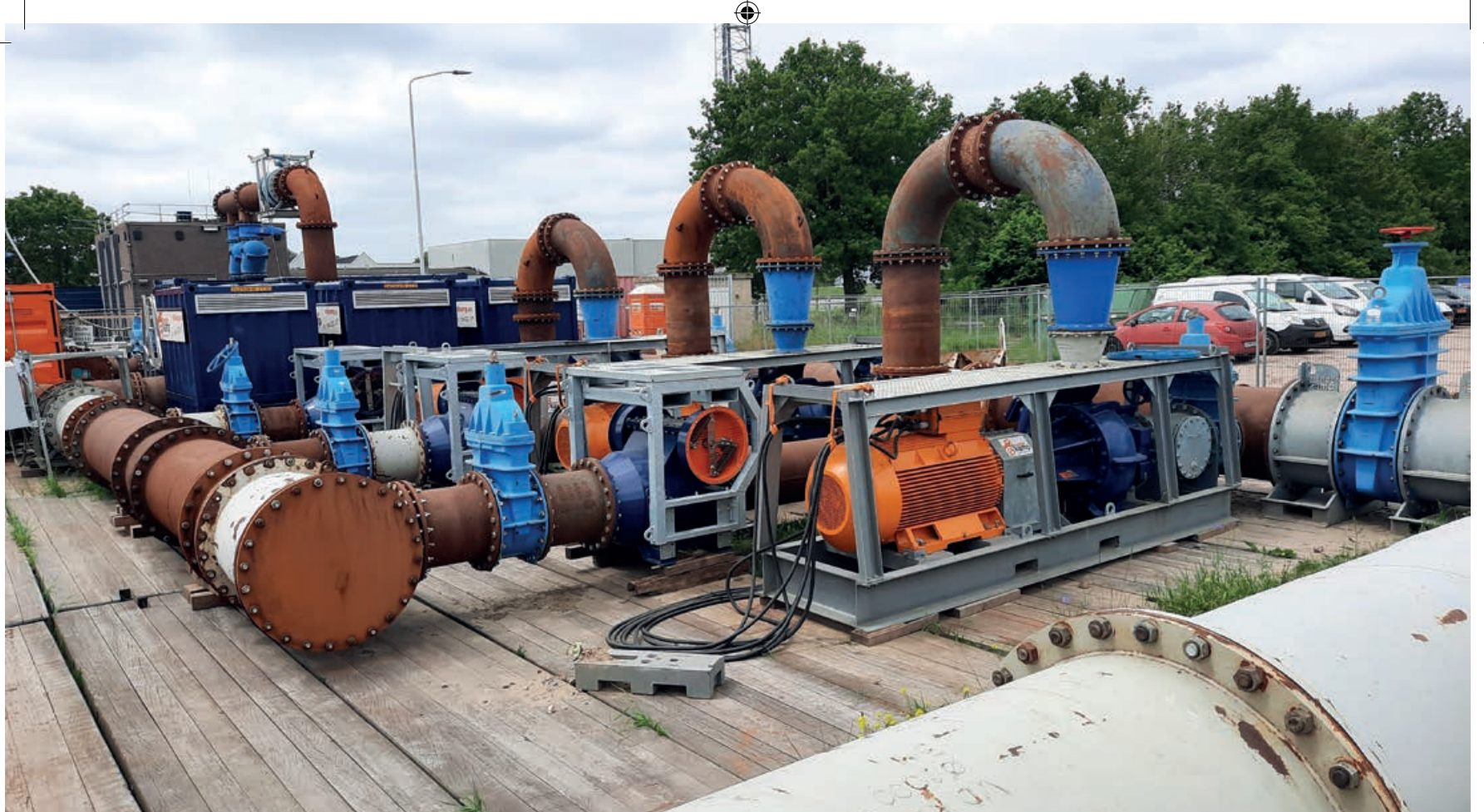
Op de voorgrond de Booster-TPI (2+1 opstelling) met op de achtergrond in de blauwe container de IHM TPI (1+1 opstelling).
