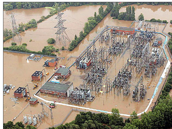
Figuur 13: Het elektriciteitsverdeelstation in Walham wordt beschermd met zandzakken tegen het water. Dit station overstroomde op 24 juli 2007 in Gloucester, Engeland
